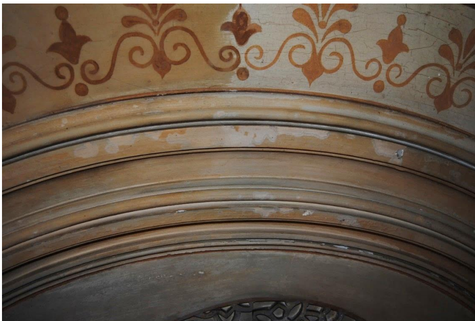
Figura 88: Descoloração da camada pictórica das molduras do teto. Rebeca Rodrigues ©
