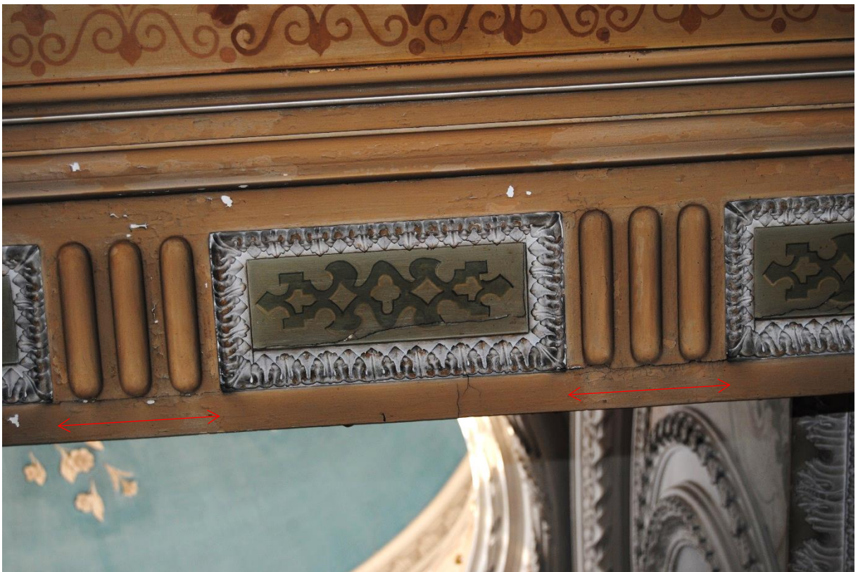
Figura 71: Detalhe da fissuração que separa as partes que compõe o friso do lado interior do teto da galeria. (Rebeca Rodrigues ©)
