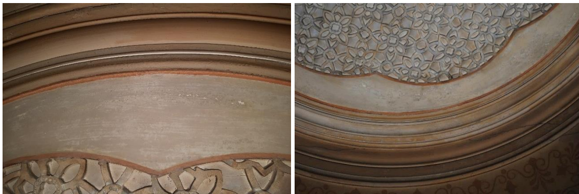
Figura 147: Detalhe de descoloração da camada pictórica e lacunas volumétricas no florão da secção norte. Rebeca Rodrigues ©
