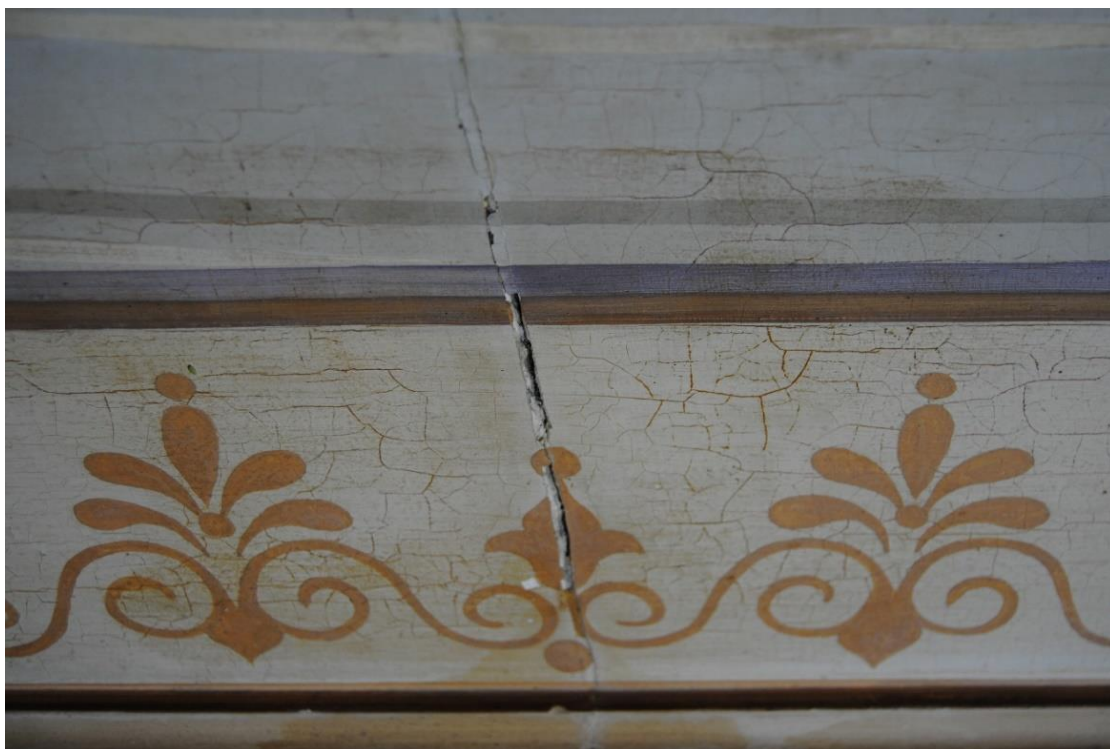
Figura 158: Abertura em v da fissura ao centro da pintura policromada. Rebeca Rodrigues ©
