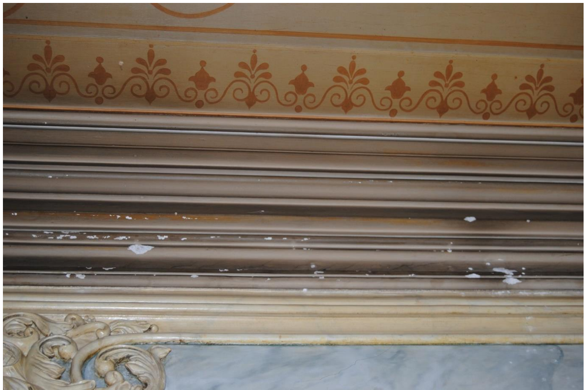
Figura 96: Lacunas volumétricas, fissuração e manchas amarelas nos frisos parietais. Rebeca Rodrigues ©
