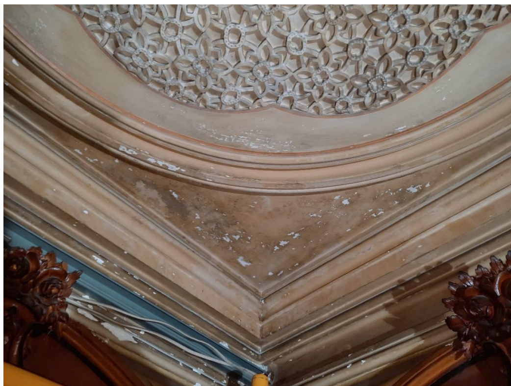
Figura 146: teto da zona norte com descoloração da camada pictórica e manchas escuras após limpeza química. Rebeca Rodrigues ©
