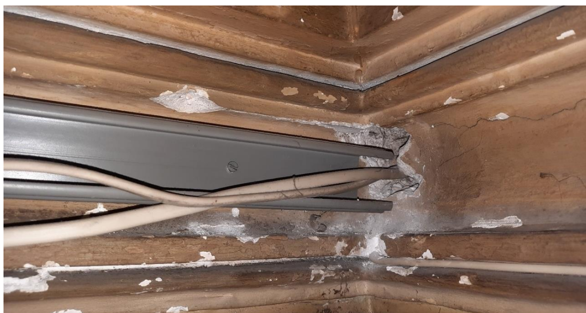
Figura 95: Lacunas volumétricas, fissuração superficial na esquina mais norte. Rebeca Rodrigues ©
