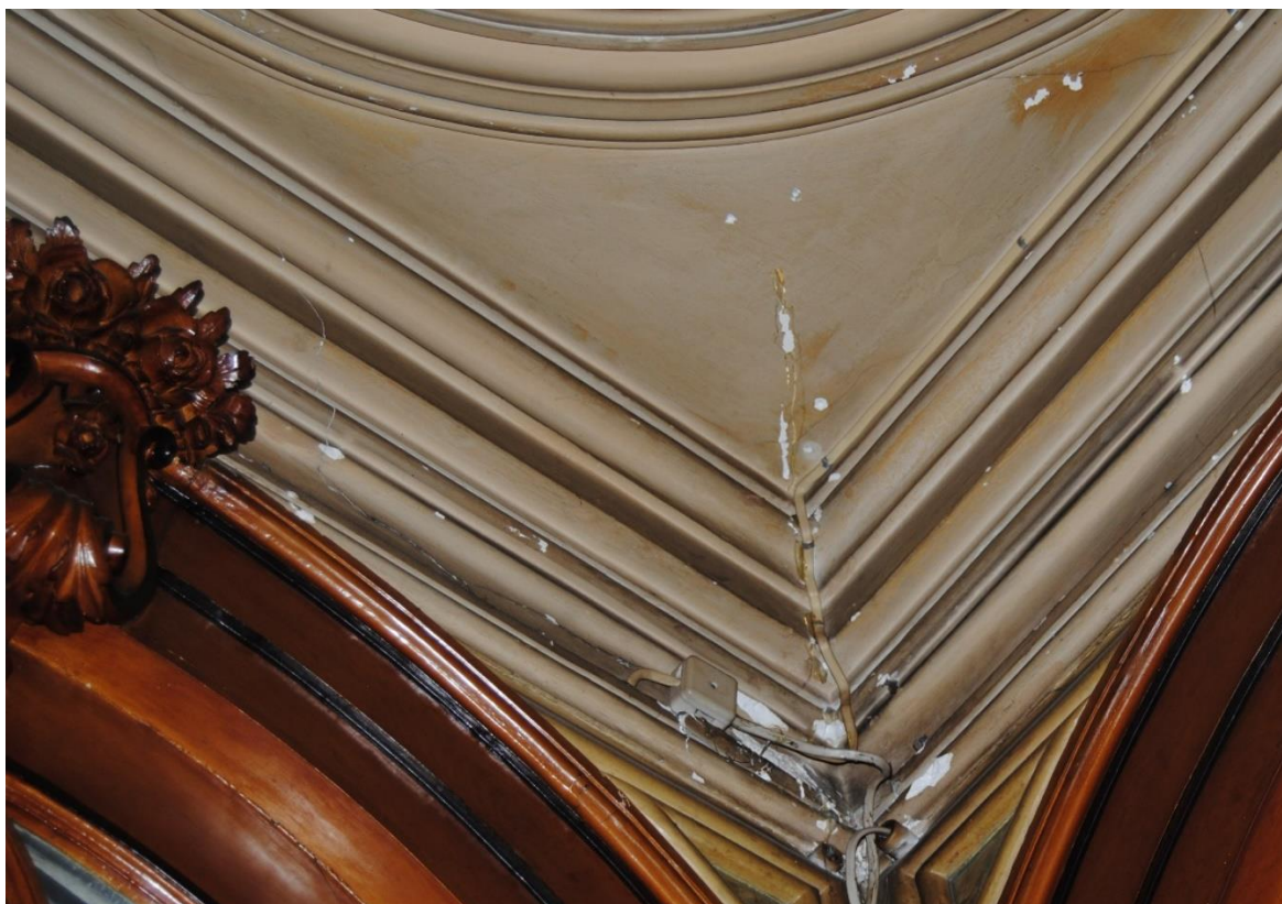
Figura 92: Esquina na área mais a sul com fissuração, repintes pontuais, colha quente, destacamento da camada pictórica e lacunas volumétricas. Rebeca Rodrigues ©
