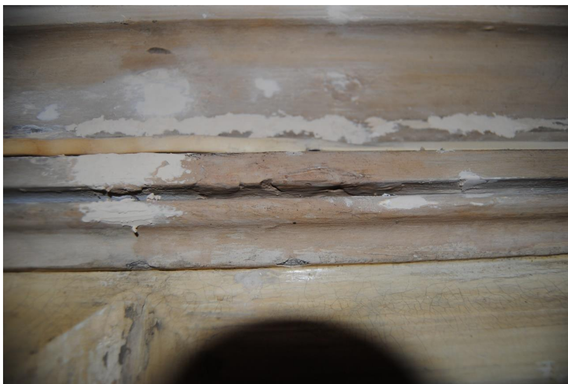
Figura 117: Intervenção anterior, com reconstrução volumétrica de lacuna, no friso parietal. Rebeca Rodrigues ©
