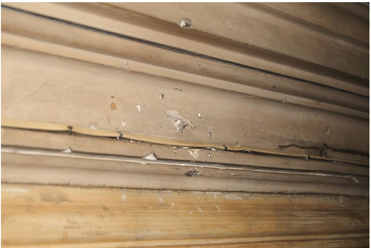
Figura 91: Lacunas volumétricas, fissuração e fios elétricos fixos por abraçadeiras e cola ao friso parietal. Rebeca Rodrigues ©
