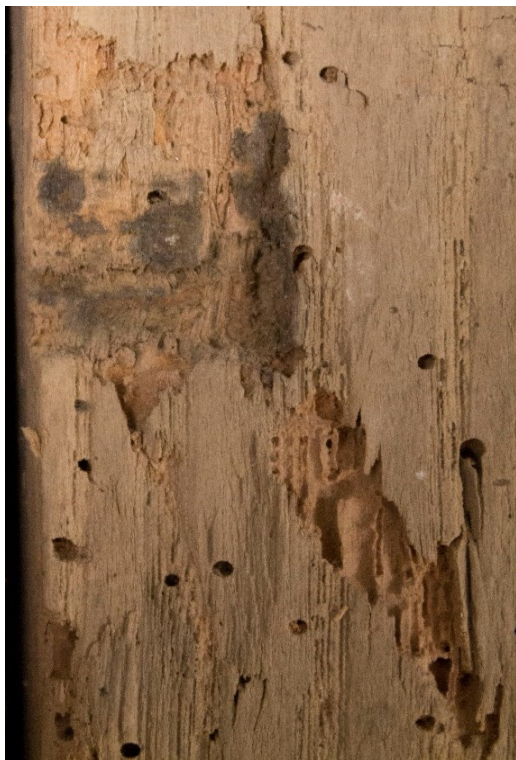
Figura Ap-IV 1. Sujidade superficial e vestígios de antiga infestação xilófaga, galerias, orifícios de saída e serrim.
