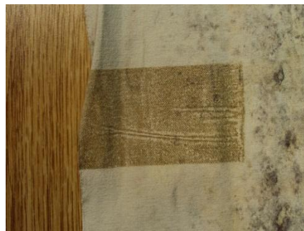
Fot. nº 34 – Marca provocada pelo uso de fita adesiva
