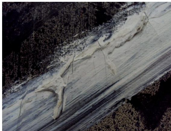
Fot. nº 86 - fissuras em área de empaste
