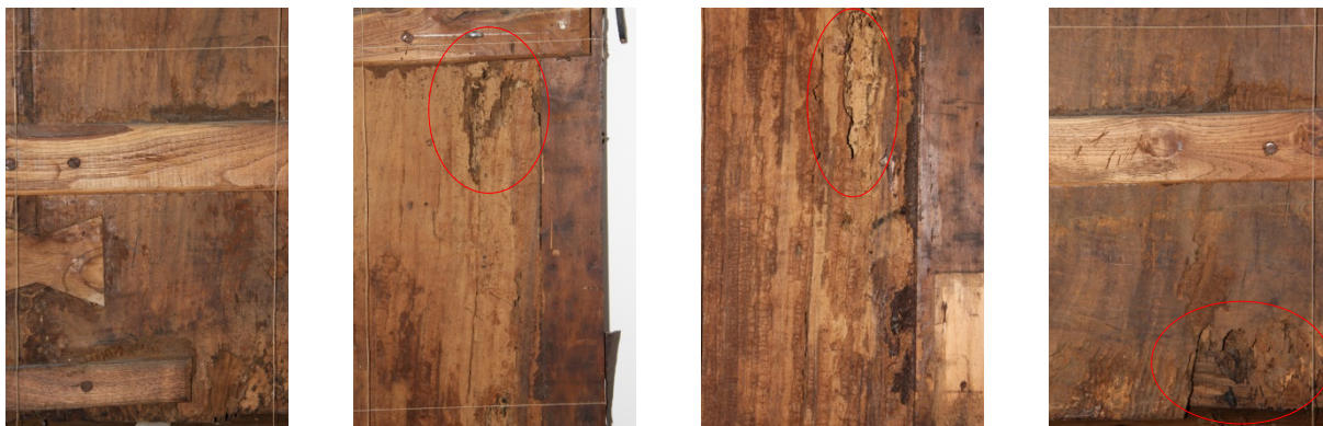
Fig. 101 - Pormenor da degradação existente na secção E4 (© Susana Mendes, 2014).
