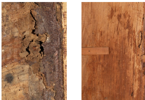
Fig. 92 - Pormenor dos agregados produzidos pela degradação das térmitas (verso) (© Susana Mendes, 2014).
