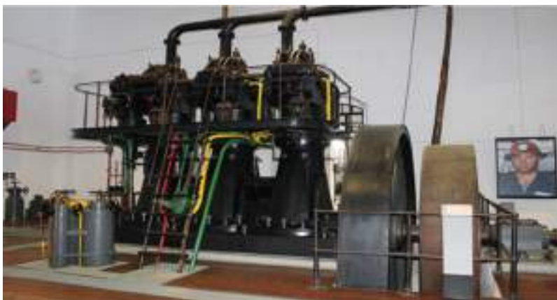
Fig 5 - Gerador a diesel, marca: Carels Ingersoll-Rand, data de instalação: 1934.
