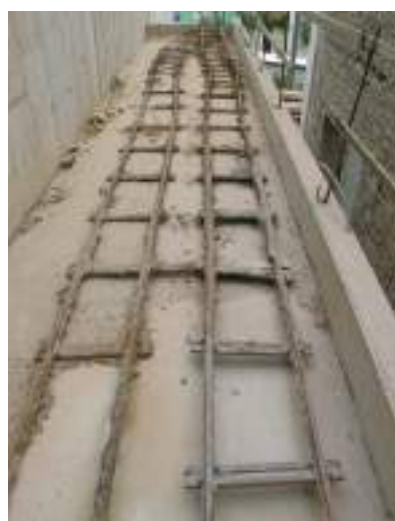
Fig. 13 - Detalhe do estado de conservação dos carris da cave após a sua remoção.
