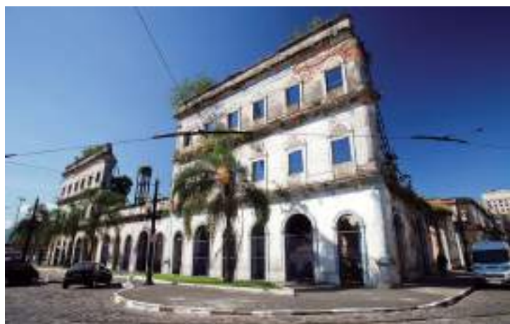
Fig. 2 - Estado em que se encontravam os antigos casarões do Valongo em 2009. Foto: Nelson Toledo.
