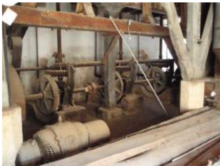
Fig.7 - Conjunto de engrenagens, piso 0, Foto de autor (30, Set. 2011).
