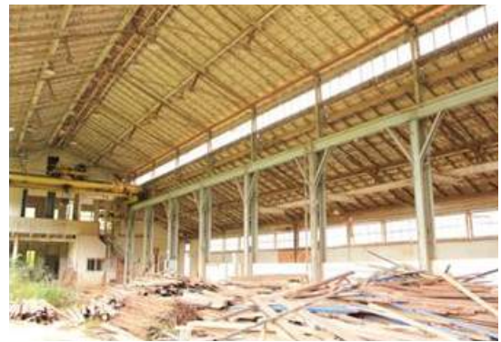
Fig. 6 - Foto interna Elétrica - Morro Velho. Fonte: Acervo Pessoal - 22/06/12.
