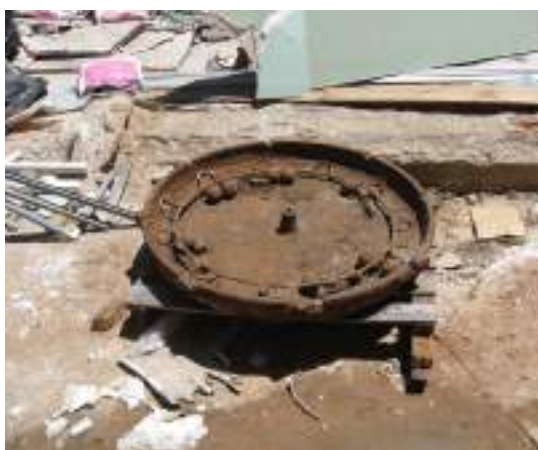
Fig. 9 - Pormenor do sistema de rotação da linha da vagoneta da sala do carvão às caldeiras.
