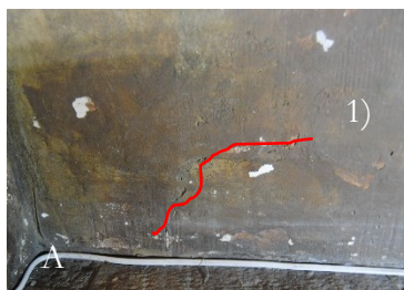
Fig. 49 – Eflorescências e fendas. (25.05.21) Margarida Nunes©
