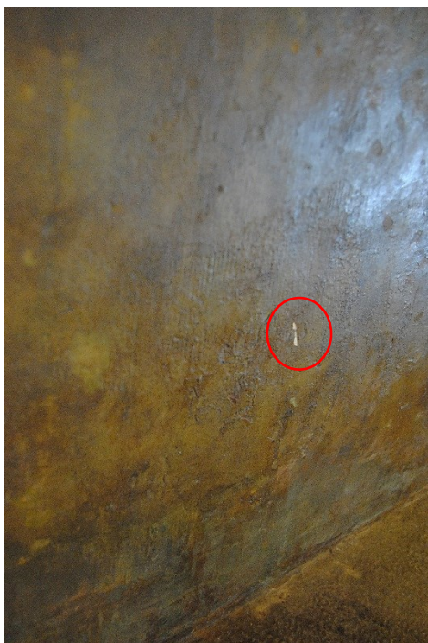
Fig. 139 – Aspecto geral da zona de ocorrência do dano, produzido após intervenção. (10.06.2022) Margarida Nunes©
