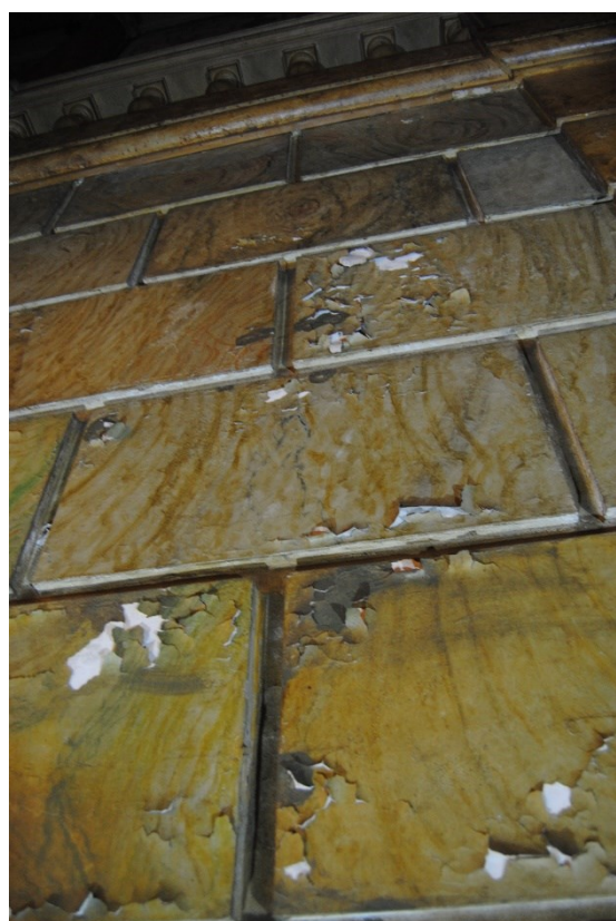
Fig. 64 – Empolamentos e destacamentos de policromia. (11.06.21) Margarida Nines©
