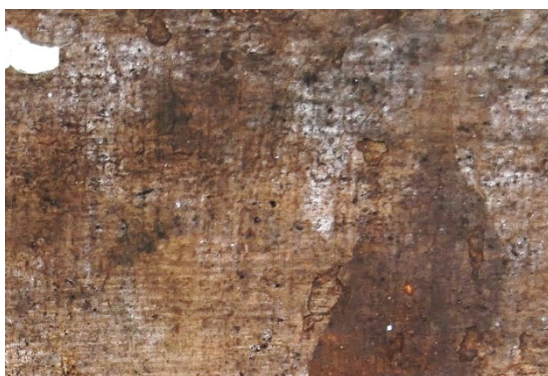
Fig. 56 – Eflorescências à superfície. (25.05.21) Margarida Nunes©
