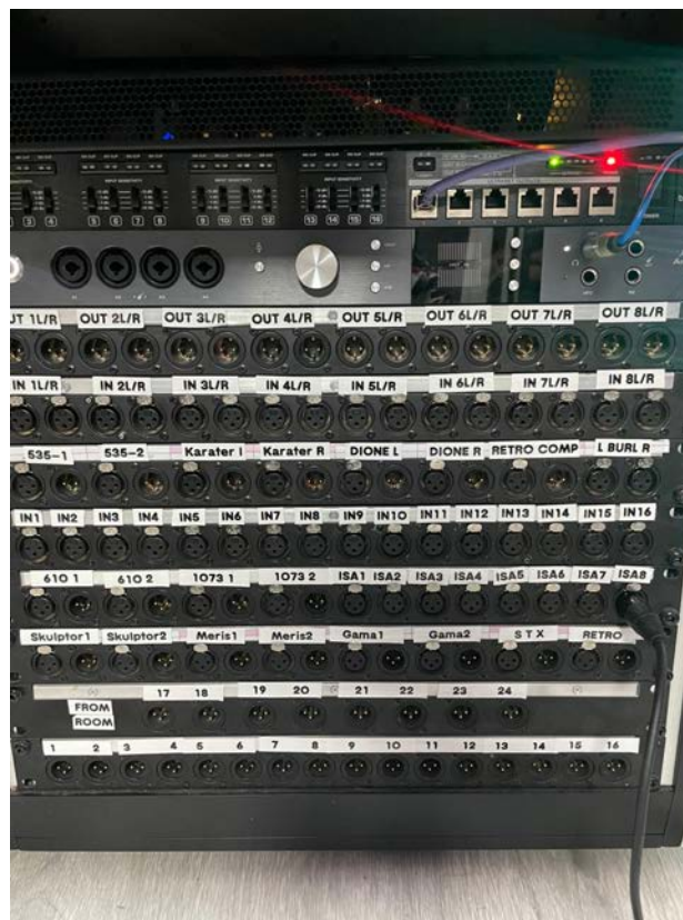
Figura 17 Labelling de patch bay (Fonte: Elaboração própria, 2024)
