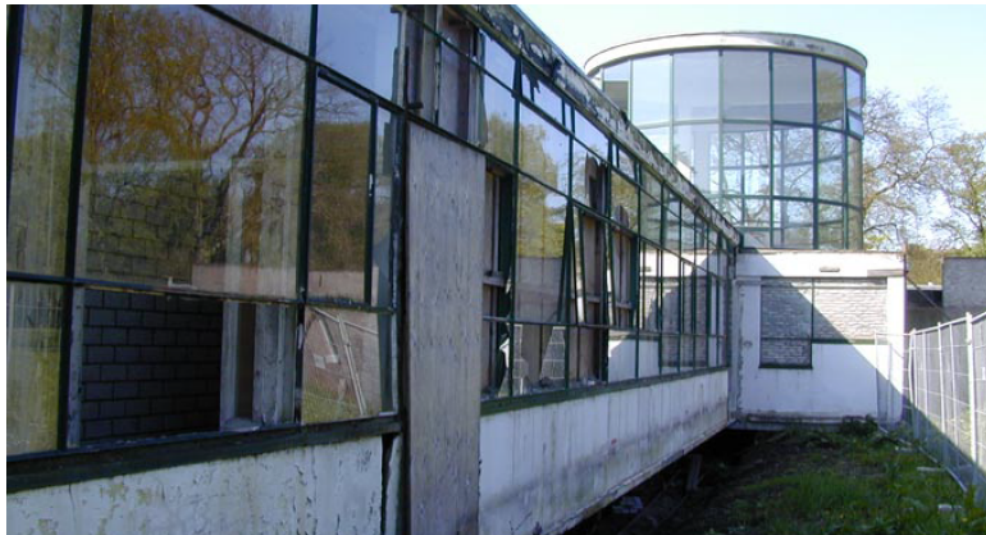
Figura 120 - Ruínas do Sanatório Zonnestraal
