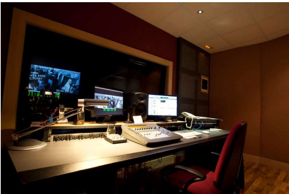
Figura 2 – Sala de controlo referente à Sala 3.
