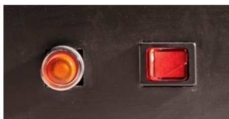
Fig. 38. Exemplo de indicador/piloto amarelo circular e interruptor luminoso basculante vermelho pertencentes ao elemento 5. Fonte: ©Francisca Lafuente.
