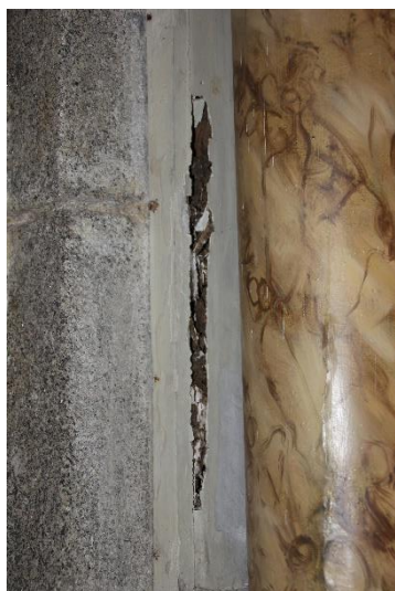
Figura 14 - Lacuna de suporte na prancha esquerda da pilastra do lado esquerdo
