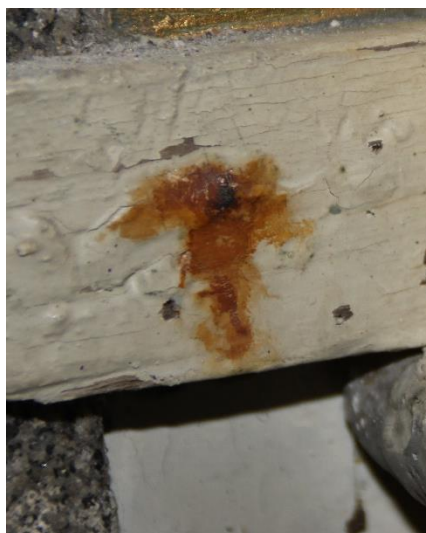
Figura 16 - Pormenor de uma mancha da superfície policroma causada por produtos de corrosão de pregos em ferro
