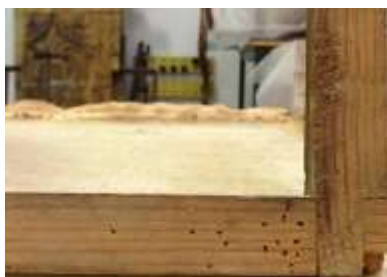
Fig. 39 - Pormenor da grade afetada pelo ataque de insetos xilófagos.
