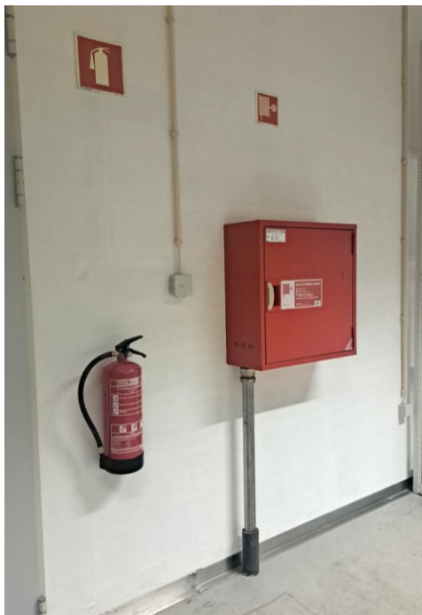
Fig. Apêndice 13 – Extintor e mangueira de incêndio instalados na antecâmara. Fotografia da autora.
