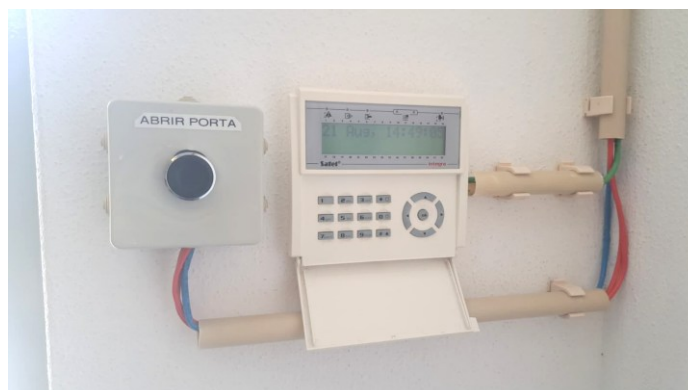
Fig. Apêndice 12 – Sistema de alarme do edifício do fórum cultural. Fotografia da autora.
