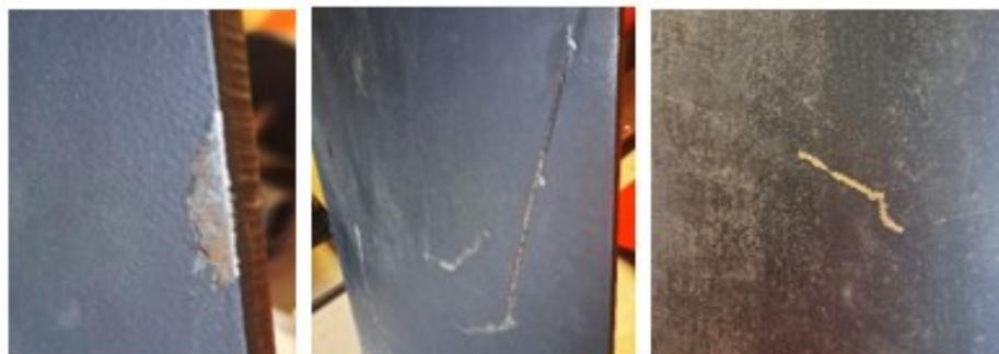
Figura 5, 6 e 7 – Pormenores das zonas com abrasão e, conseqüentemente, destacamentos da camada cromática e corrosão pontual.
