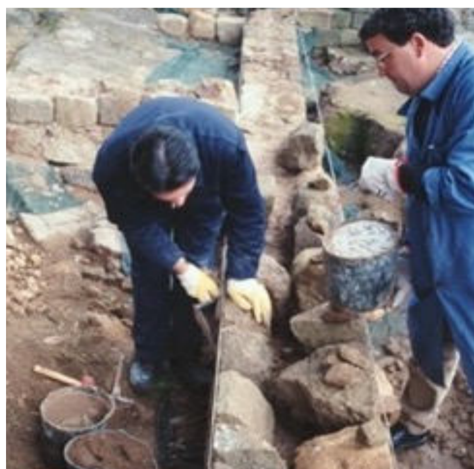
Fig. 4 Reconstrucción de uno de los muros de las Termas Romanas del Alto da Cidade, entre 1991-1998. Archivo del Museu D. Diogo de Sousa © Braga.
