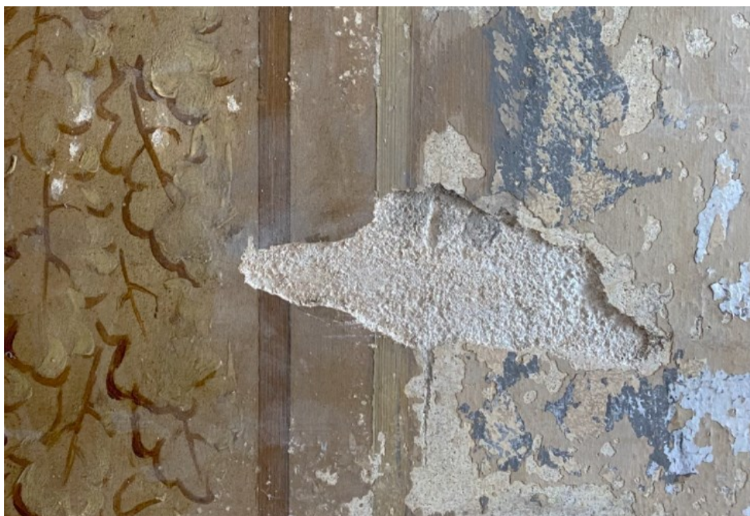
Figura API – B.19 - Destacamento da camada de preparação, na pintura mural "Barcos". Cíntia Freitas©
