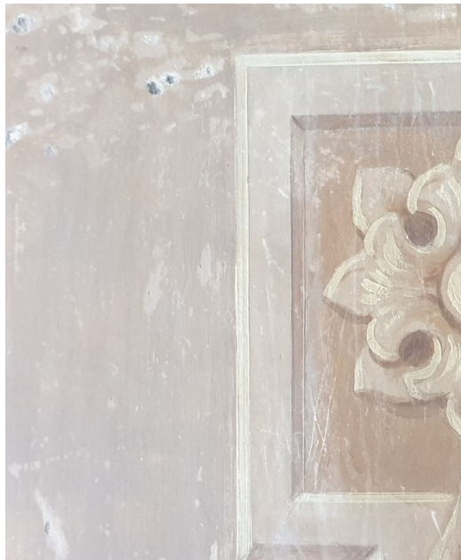
Figura API – B15 - Exemplo de dano de abrasão, observado na pintura mural "Moinho". Cíntia Freitas©
