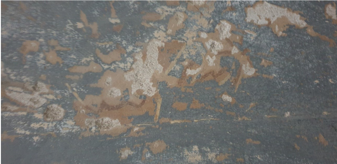
Figura APIII – A82 - Pormenor da pintura original da parede pertencente à pintura "moinho" após o dano provocado pela decapagem mecânica . Cíntia Freitas©
