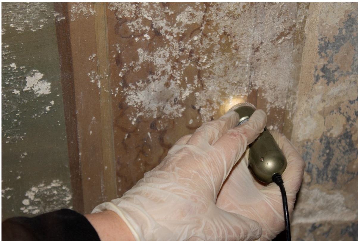
Figura APII – A33 - A4: Execução da documentação por Microscopia Ótica Digital Portátil, na moldura de cor castanha, com presença de sais solúveis na forma de eflorescência, da pintura mural "Barcos". Cíntia Freitas©
