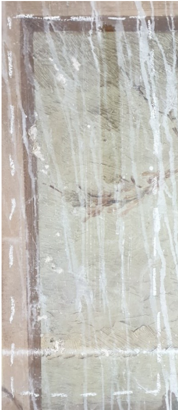
Figura API – B11 - Zona de lacuna e destacamento da camada de cromática na pintura mural "Moinho". Cíntia Freitas©
