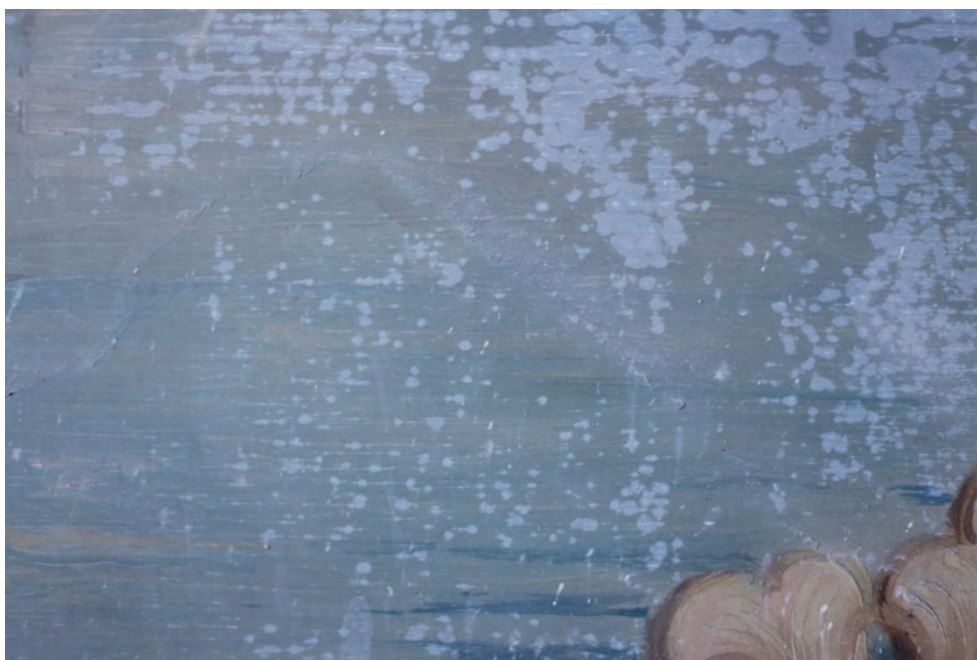
Figura API – B18 - Exemplo de zona de fissura, observada na pintura mural "Barcos". Cíntia Freitas©
