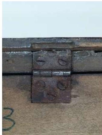
Figura 14 - Oxidação dos elementos metálicos
