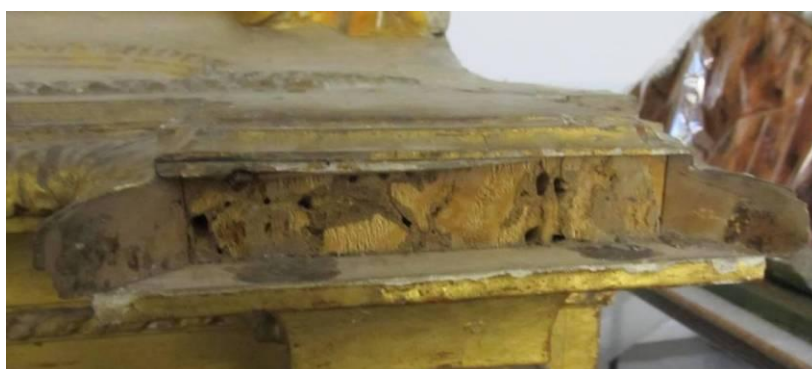
Fig. 2 Desprendimento de elementos volumétricos do emolduramento da cornija.
