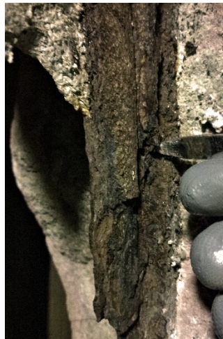
Figura 246 Aspecto del acero corroído en la pierna derecha de a figura masculina.
