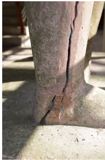
Figura 11 Grieta en pierna derecha de figura femenina.
