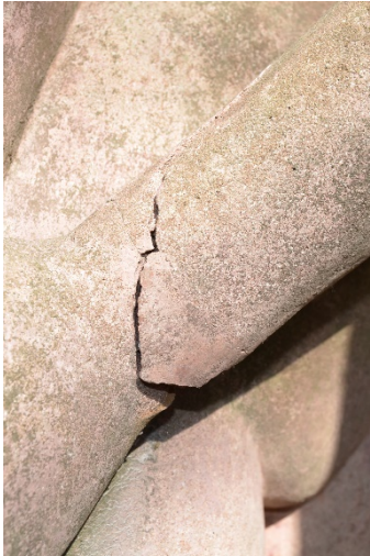
Figura 15 Agrietamiento y levantamiento en muñeca izquierda de figura masculina.
