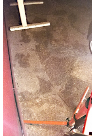
Figura 278 Humedad ascendiendo desde la capa freática al suelo de la zona donde se realizaba la intervención de conservación – restauración de la escultura.
