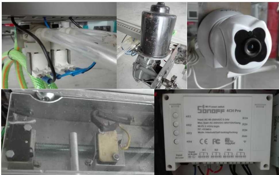
Fig. 3 – Realização prática de um projeto da PAP do curso de Técnico de Eletrotécnica
