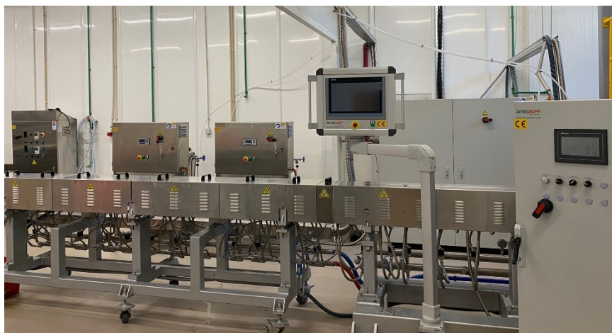
Figura 6- Extrusora e painel de controlo da NFC
