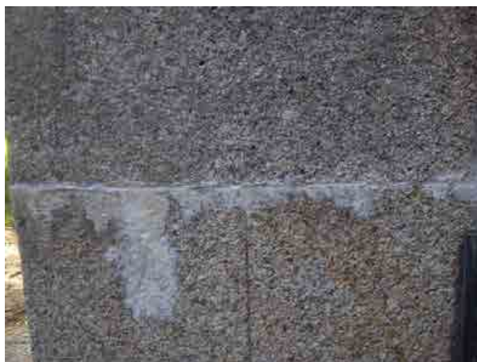
Figura 3 - Depósitos característicos de escorrências decorrentes do contacto das argamassas com infiltrações de água [Autora].
