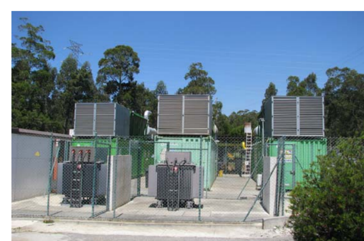
Figura 1 - Estação de Valorização Energética de Biogás
