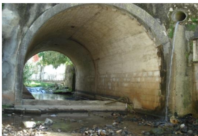
Figura 6.3 - Caudal proveniente de conduta que resta do sistema hidráulico original de abastecimento ao PNQ, na secção extrema norte do Canal de Queluz (07/10/2013)
