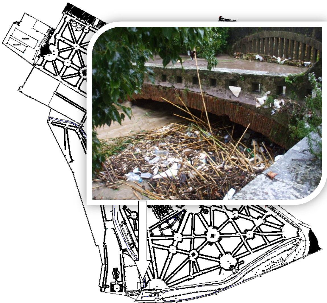
Figura 2.18 - Acumulação de material sólido na entrada da ponte (vista de montante) (2008) (fotos: Herculano do Rosário, PSML)
