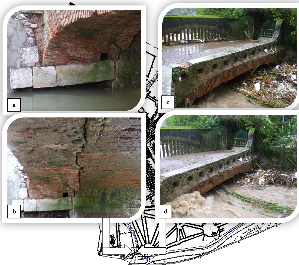
Figura 4.7 - a) Assentamento de fundação; b) Danos na estrutura de alvenaria (vista de baixo); c) e d) Acumulação de material sólido na entrada da ponte (vista de montante) (2008) (fotos: Herculano do Rosário, PSML)
