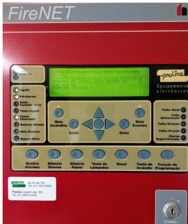
Figura 35: sistema automático de proteção contra incêndio. Fonte: foto do autor
