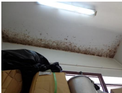
Figura 4- Teto em mau estado de conservação/limpeza
