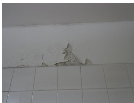
Figura 18- Deficiente estado geral de conservação
