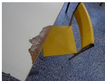
Figura 21- Estado geral de conservação deficiente na sala de refeições
