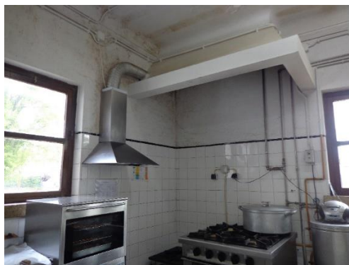
Figura 17- O sistema de extração de fumos/cheiros/vapores apresenta avaria no seu funcionamento
