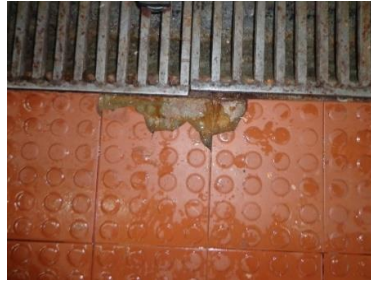
Figura 1- Pavimento com saliências e cavidades
