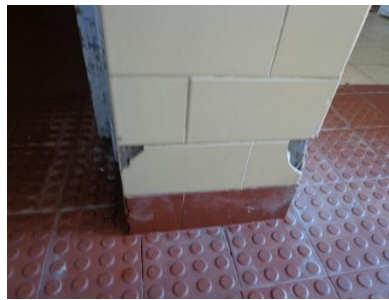
Figura 2- Paredes em mau estado de conservação
