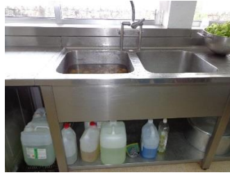
Figura 6- Local de armazenagem de substâncias perigosas inadequado
