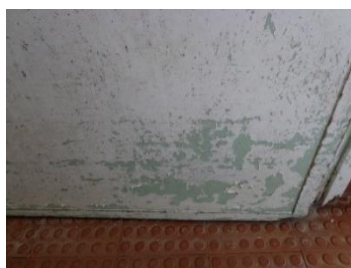
Figura 5- Porta em mau estado de conservação
