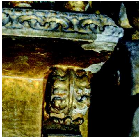
Fig. 36 – Pormenor de lacunas, desgaste e pulverulência da camada de preparação na área do coro alto.
