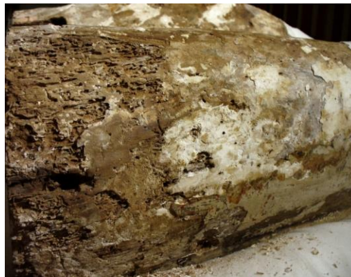
Fig. 157 - Degradação do suporte.
