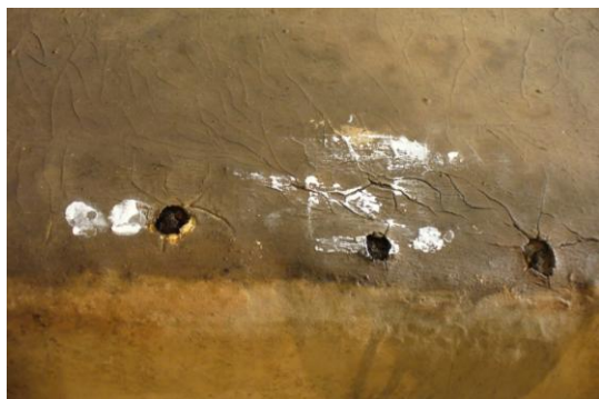
Fig. 172 – Furos na pele provocada pela corrosão dos pregos.
