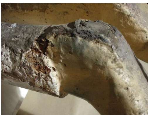
Fig. 169 - Calcânhar com madeira à vista.
