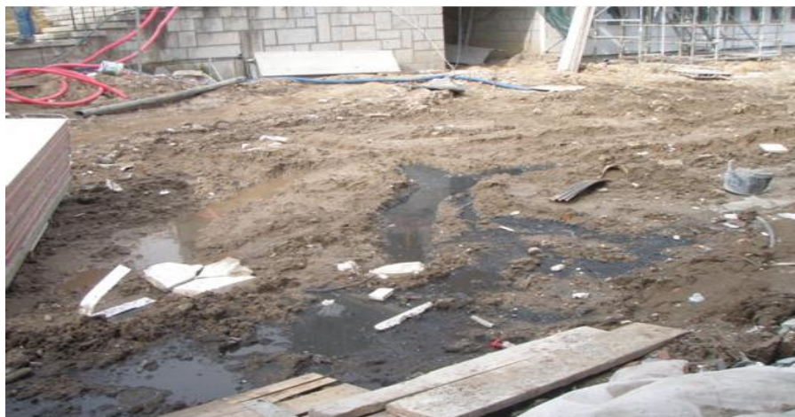
Figura 21: Resíduos gerados no decorrer da obra
