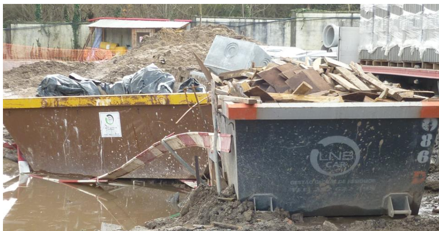
Figura 24: Resíduos gerados no decorrer da obra
