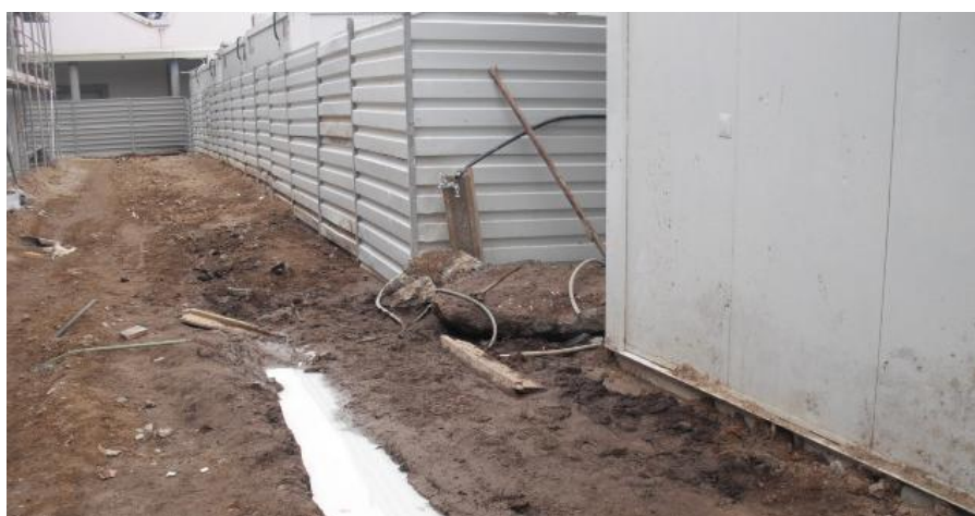
Figura 22: Resíduos gerados no decorrer da obra
