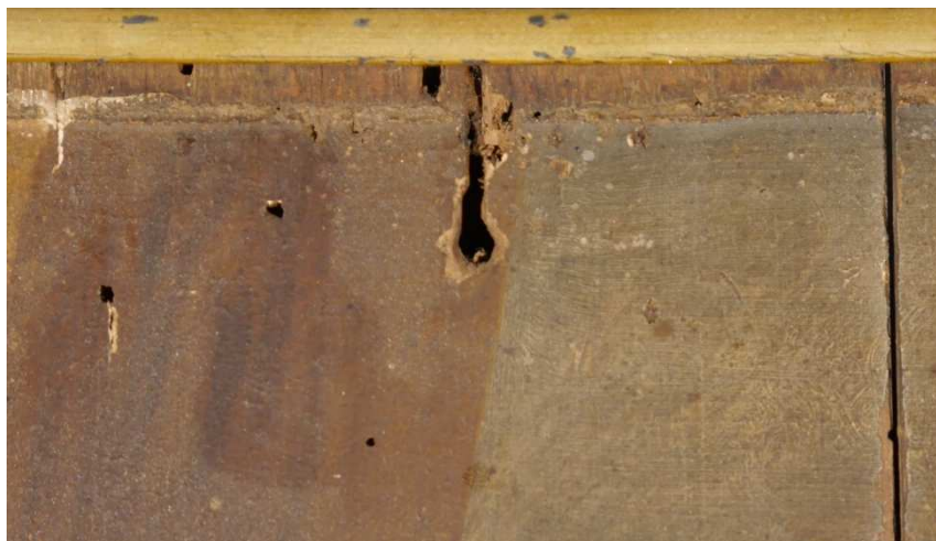
Figura 15 – Dano causado pelo homem (para pendurar a moldura)
