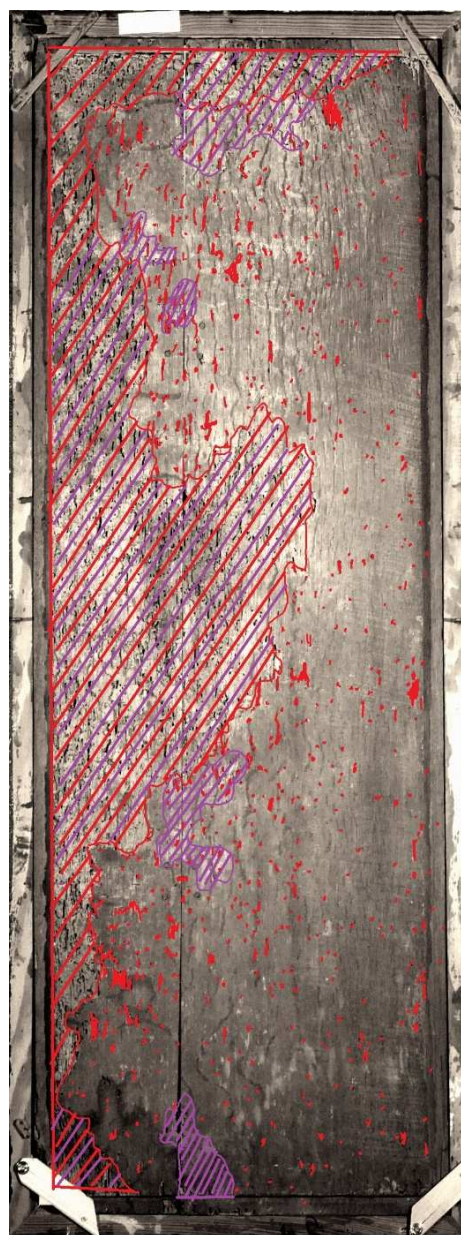
Figura 12 - Mapeamento das principais patologias, verso
