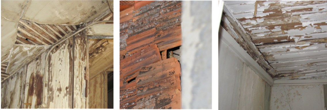
Figura 5.1 – Diferentes anomalias resultantes da falta de manutenção dos edifícios.
