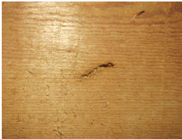
Figura 9.14 – Indício de ataque biológico nos vigamentos de madeira.
