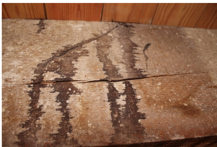
Figura 7.3 – Fendas e humidade num vigamento de madeira.
