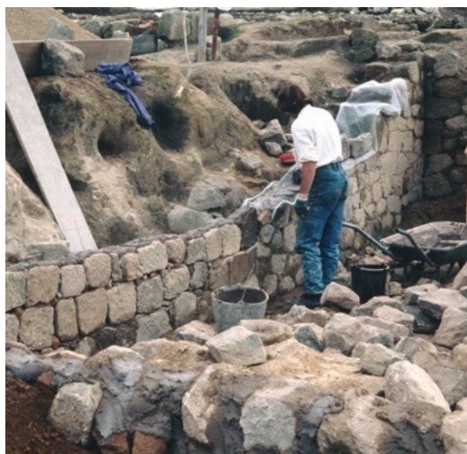
Figura 9 Reconstrução de um dos muros da Insulae das Carvalheiras ( Bracara Augusta ), a 15 de novembro de 1991. Créditos: Arquivo do Museu D. Diogo de Sousa © Braga.
