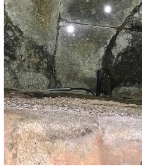
Figura 6 Vista de pormenor do sensor de monitorização presente na Piscina A. Créditos: Mariana N. Durana Pinto © 2022.
