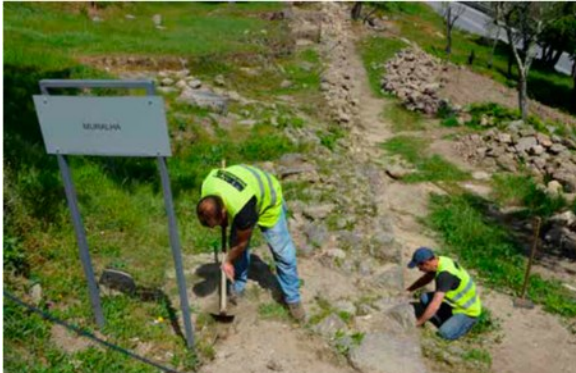
Figura 23 Trabalhos de limpeza e remoção da vegetação, na zona da muralha em Tongobriga. (Lima et al., 2020, p. 163).
