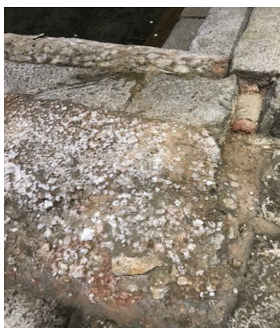
Figura 7 Vista de pormenor dos sais solúveis presentes na borda da Piscina A. Créditos: Mariana N. Durana Pinto © 2022.
