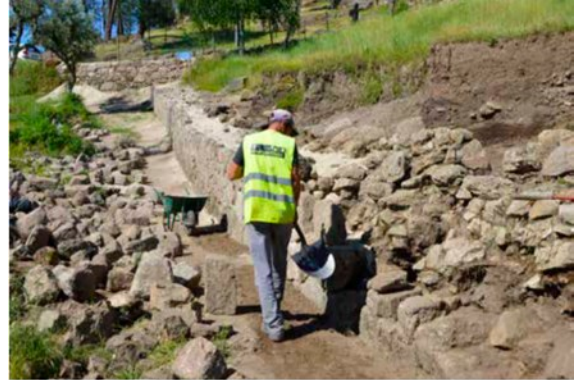
Figura 24 Pormenor dos trabalhos de consolidação da muralha (em Tongobriga). (Lima et al., 2020, p. 169).
