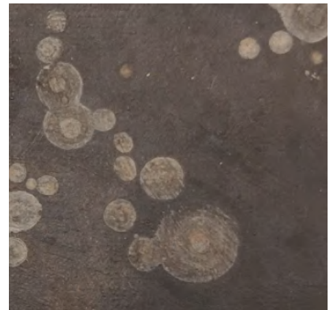
Figura 13- Exemplo de manchas na superfície da pintura.
