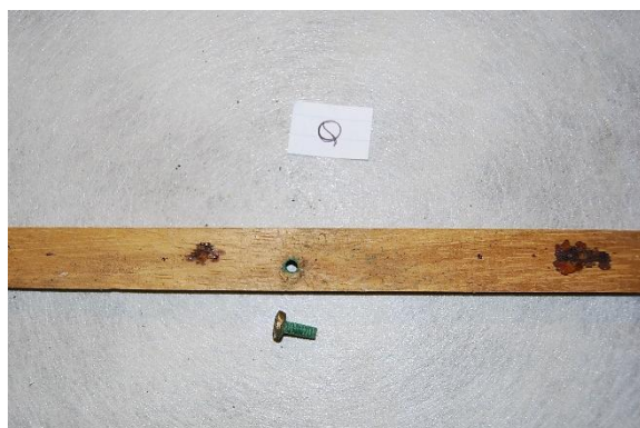
Imagem 130 – Alteração de cor da madeira devida aos produtos de corrosão.
