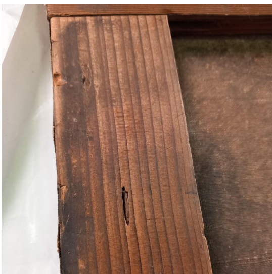
Figura 49: Detalhe da sujidade acumulada na grade.
