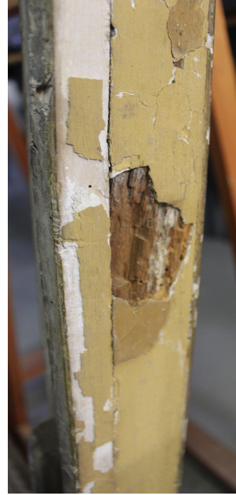
Figura 38: Detalhe da lacuna volumétrica existente na lateral da moldura.
