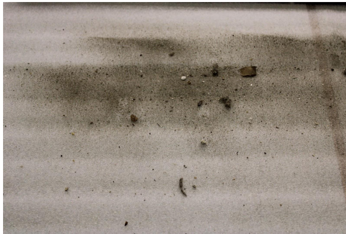
Figura 48: Sujidade existente entre o suporte e a grade.
