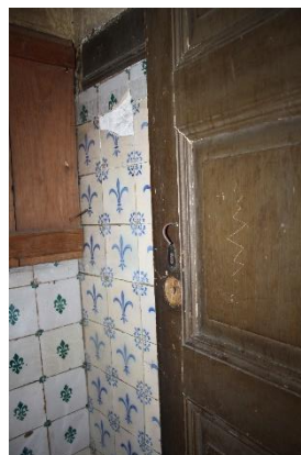
Imagem 37 – Falta de puxador e fechadura
