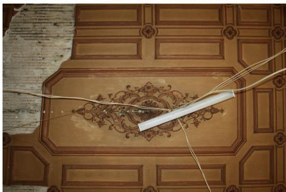
Imagem 40 – Destacamento do estuque do teto
