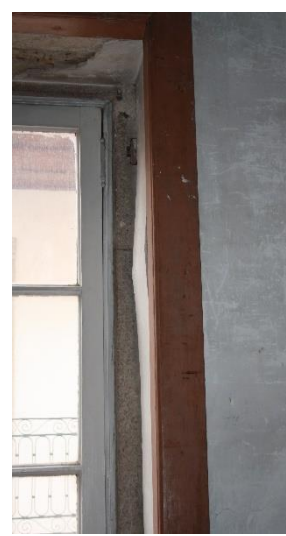
Imagem 34 – Degradação do vão e moldura
