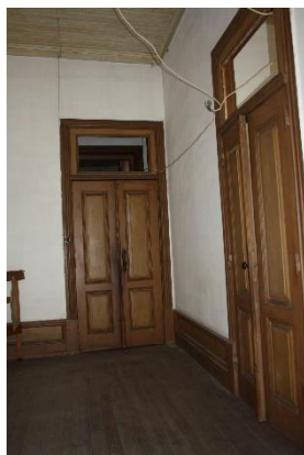
Imagem 36 – Falta de vidro superior
