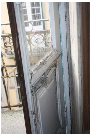
Imagem 32 – Deterioração do caixilho
