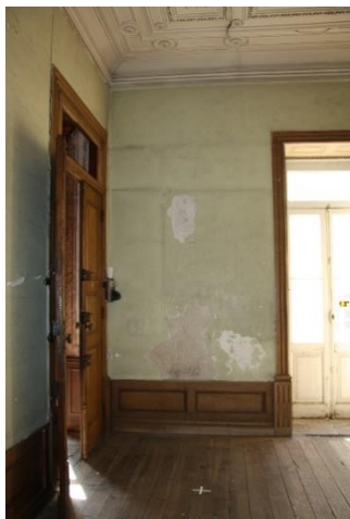
Imagem 45 – Destacamento do reboco das paredes
