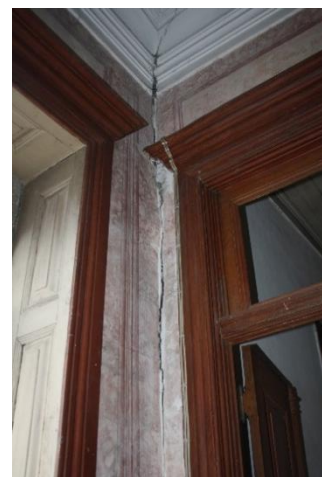
Imagem 47 – Fendilhações no reboco
