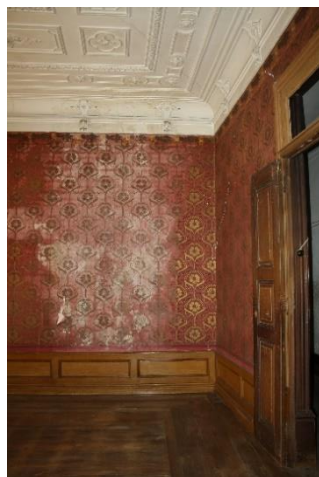
Imagem 46 – Manchas de humidade
