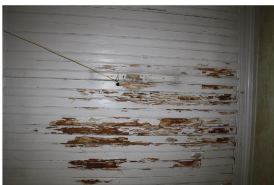
Imagem 42 – Eflorescências da madeira do teto
