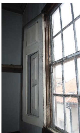
Imagem 33 – Deterioração da janela de guilhotina
