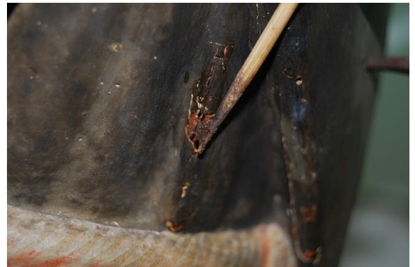
Fig. 831 - Preenchimento dos orifícios de saída de insetos com massa à base de microsferas fenólicas.
