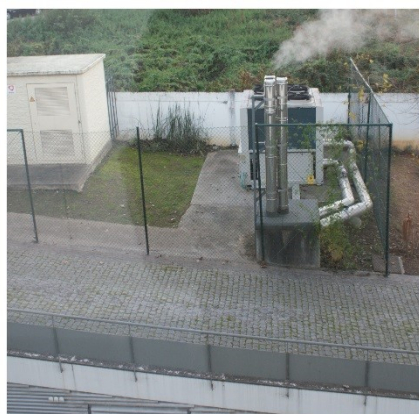
Fotografia 25 – Caldeiras do sistema de aquecimento central
