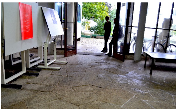
Fig. 120 Entrada del hall del pabellón Carlos Ramos, suelo mojado por ascenso de humedad, por tránsito de alumnos y por puerta permanentemente abierta.
