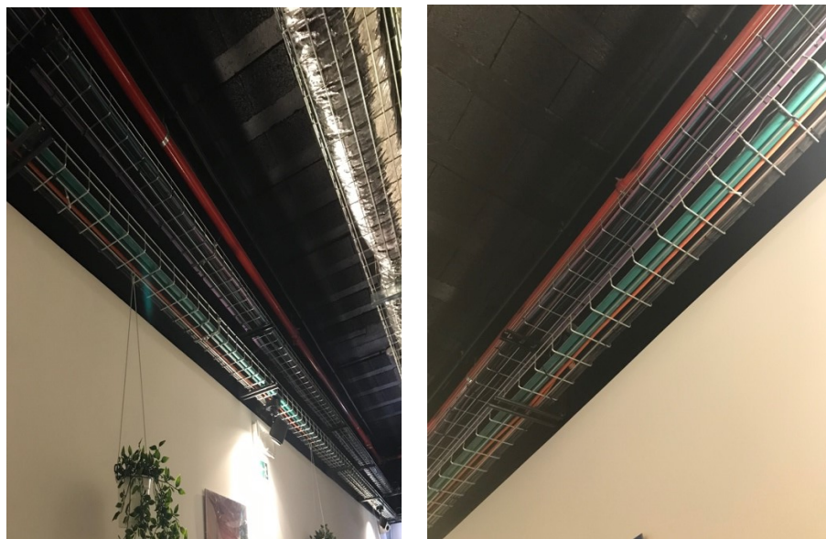
Figura 7 - Vias aéreas de cabos em esteiras metálicas
