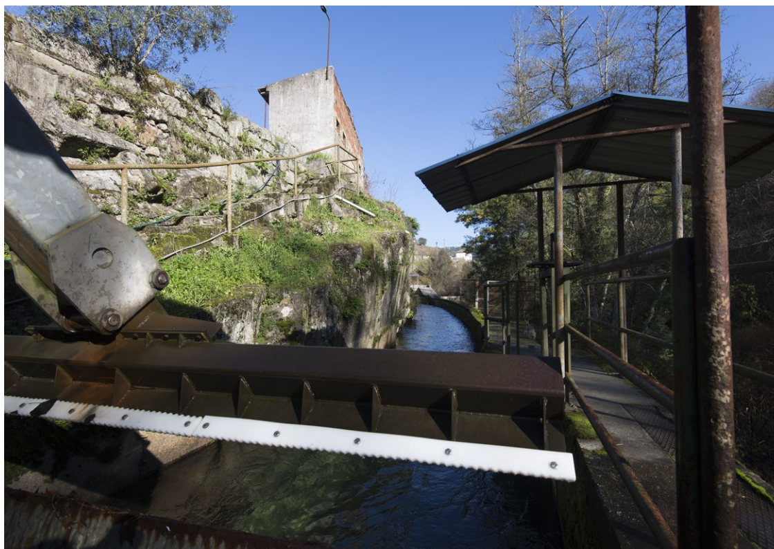
Fig. 94 - Comporta 2 e grelha de filtragem na entrada da levada subterrânea (©MBPastor).
