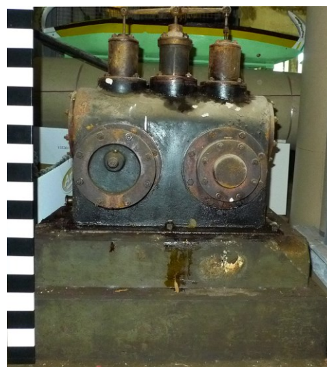
Fig. 33 - Vista frontal do mesmo controlador de fluxo (©MBPastor).
