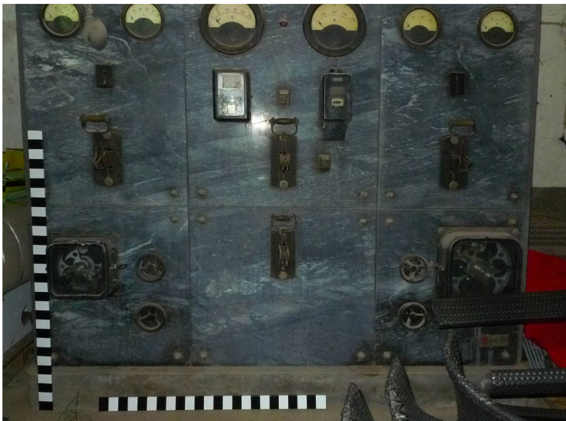
Fig. 34 - Quadro de monotorização da produção elétrica (©MBPastor).
