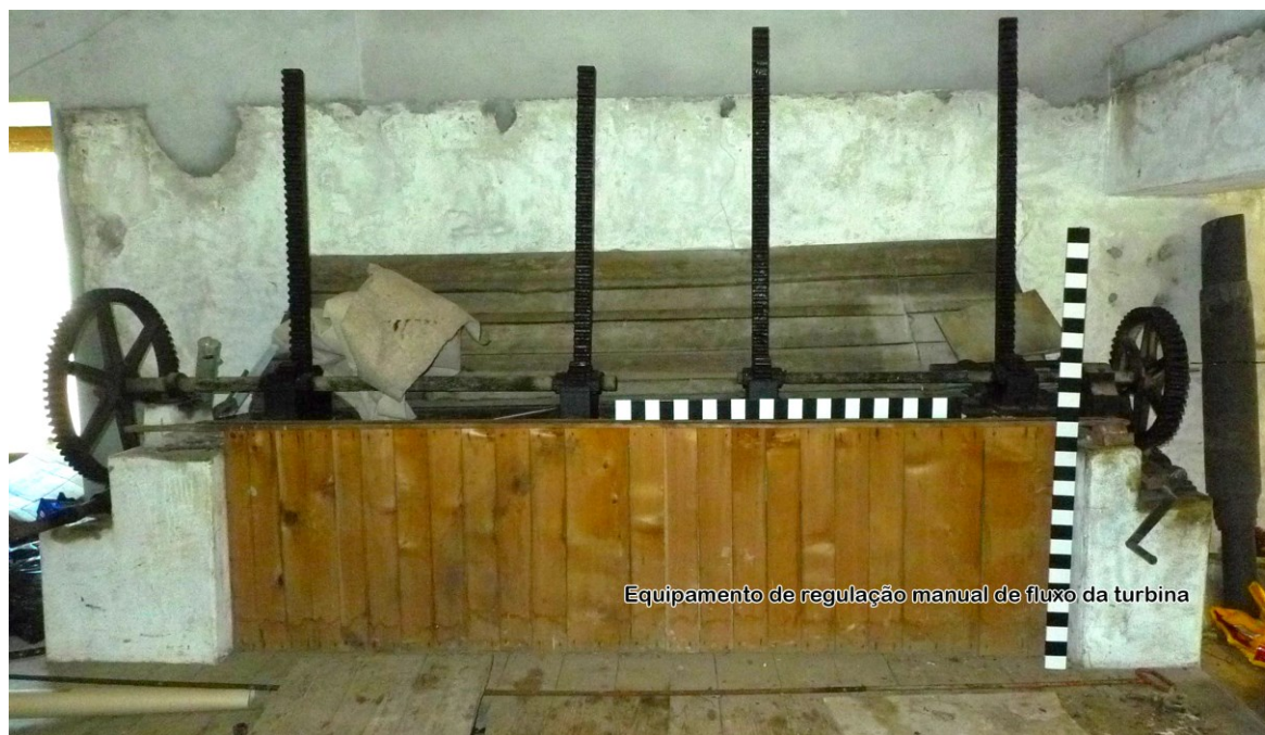
Fig. 29 - Engrenagem de regulação manual do fluxo de água da turbina Knop da Costas & Carvalho (©MBPastor).
