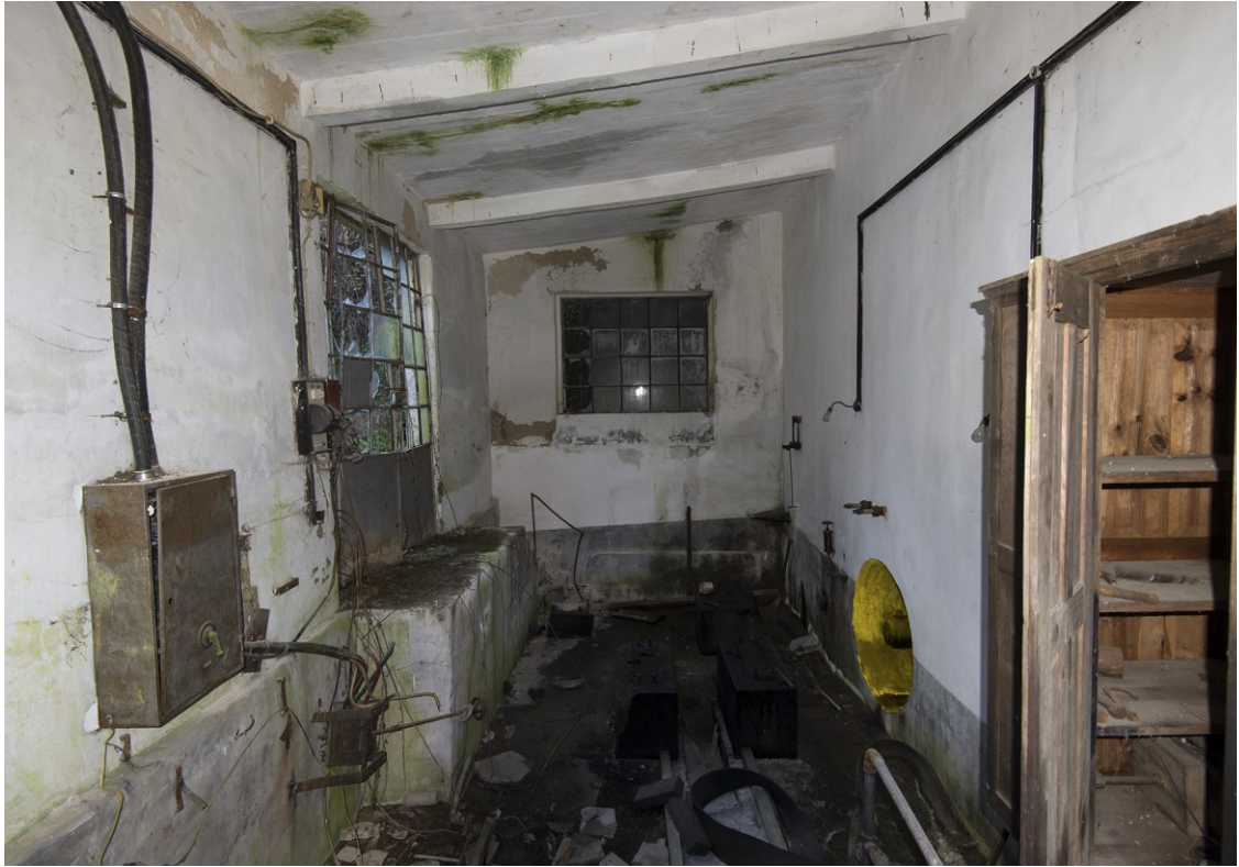
Fig. 98 - Central hidroeléctrica, interior (©MBPastor).
