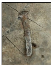
Figura 13 - Elemento metálico oxidado (©Diana Tavares);
