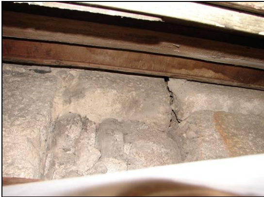
Fig.69 – Pormenor do chão onde assenta a obra, onde é visível a perda das argamassas de ligação das pedras.
