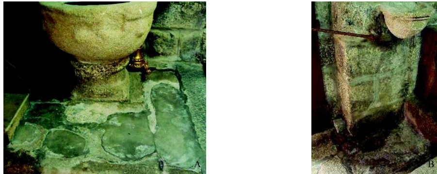
Figura 130. Aplicação de argamassa de cimento no chão da igreja à entrada do pórtico principal (fachada Oeste): (A) Aos pés da pia baptismal, no canto da fachada O com a N. (B) Sob a pia de água benta no lado direito do pórtico principal conjuntamente com mancha de humidade entre o chão e a parede. ©2013, A Autora
