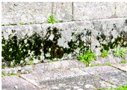
Figura 112. Biocolonização do rodapé por musgos, líquenes e plantas predominantemente nas juntas e solo. ©2013, Eduarda Vieira
