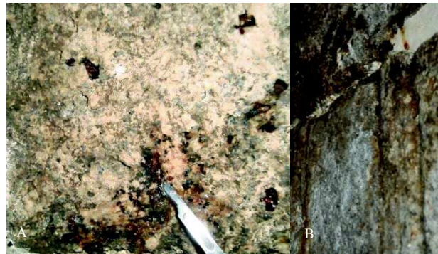
Figura 119. Água a brotar do interior do granito na fachada Sul: (A) Pitting e escamação; (B) Escorrências laranja, devido possivelmente à água entrar em contacto com os metais constituintes da rocha. ©2013, A Autora
