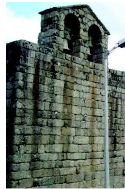
Figura 111. Escorrências com biocolonização negra e quatro zonas de escorrências de coloração alaranjada, possivelmente devidas à oxidação dos elementos metálicos existentes (sinos) e dos removidos (acesso aos sinos por escada e patamar em ferro). ©2013, A Autora
