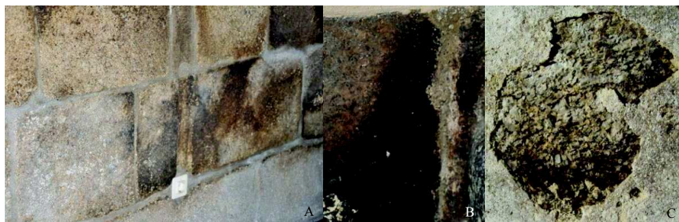
Figura 120. Alterações do granito: (A) Eflorescências salinas e biocolonização. ©2013, Eduarda Vieira; (B) Enegrhecimento da superfície por colonização fúngica (C) Plaquetas e enegrecimento da superfície por colonização biológica. ©2013, Eduarda Vieira e Frederico Henriques
