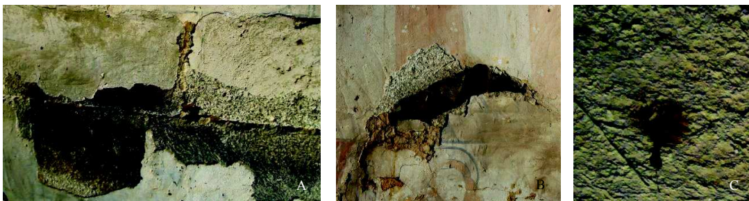
Figura 133. (A) Manchas negras no granito por biocolonização. (B) Perda de suporte em local de fixação dos altares. (C) Mancha laranja no granito por oxidação do elemento metálico. ©2015, Frederico Henriques.
