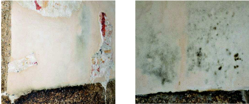
Figura 123. Biocolonização do reboco de restauro, possivelmente por contaminação advinda do suporte.
