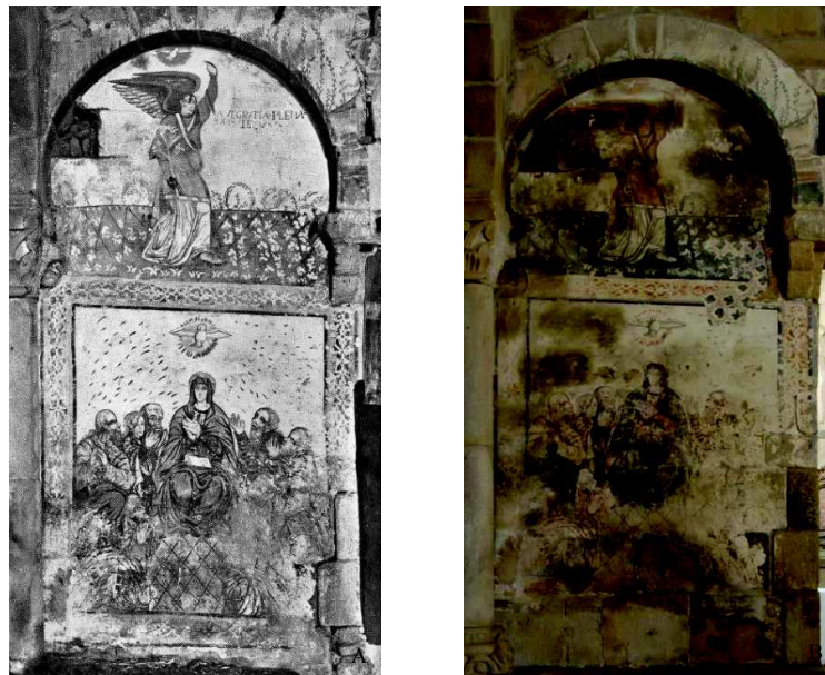
Figura 105. Aspecto das pinturas na parede do lado do Evangelho, junto ao arco triunfal na Igreja de Sta. Eulália: (A) Estado das pinturas em 1958, alguns anos após a remoção dos altares (fonte: Boletim N° 94 da DGEMN, 1958). (B) Estado das pinturas em 2015. ©2015, Frederico Henriques
