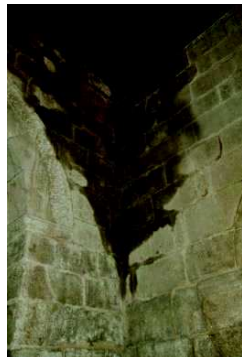
Figura 118. Humidade no canto superior NO. devido a infiltrações da cobertura de madeira. ©2013, Eduarda Vieira
