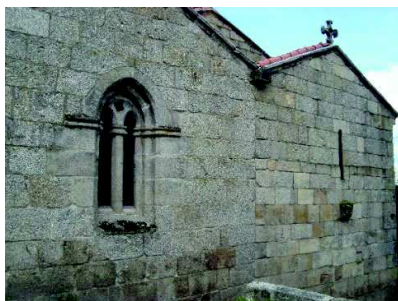
Figura 114. Biocolonização pontual nas juntas horizontais e maior incidência no parapeito da janela da sacristia, no pingadouro na união dos telhados e no cachorro sob a fresta da capela-mor. Fachada Este. ©2013, Eduarda Vieira
