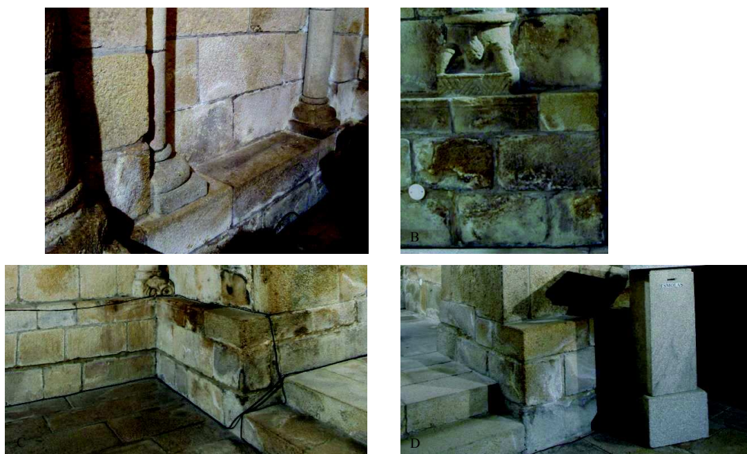
Figura 95. Eflorescências de sais, observáveis nas linhas brancas que aparecem à superfície do granito: (A) Parede N. da capela-mor; (B) Parede sul da nave; (C) Parede N da nave, arco triunfal e escadas para a capela-mor (lado do Evangelho); (D) Parede S., arco triunfal e escadas para a capela-mor (lado da Epístola). © 2015, Frederico Henriques
