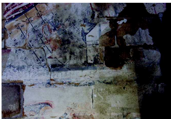
Figura 103. Fissuras da camada pictórica nas áreas de juntas do suporte granítico. ©2015, Frederico Henriques
