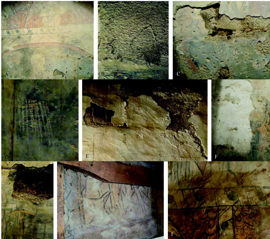
Figura 132. Alterações na camada cromática: (A) Sujidade e poeiras. (B) Teias de aranha. (C) lacunas da camada cromática e reboco. (D) Lacunas por acção humana. (E) Destacamentos da camada cromática por mau isolamento da cobertura. (F) Cal aplicada sobre as pinturas murais para colocação de altares no séc. XVIII. (G) Escorrências de uma junta aberta. (H) Eflorescências. (I) Manchas acastanhadas devidas a biocolonização. (A), (D), (E), (F) e (I) ©2015, Frederico Henriques. (B), (C), (G) e (H) ©2013, A Autora
