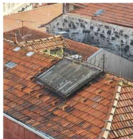
Fig. 34 – Claraboias aparentemente tamponadas por telhas de fibrocimento. Imagem captada via drone por João Pereira.
