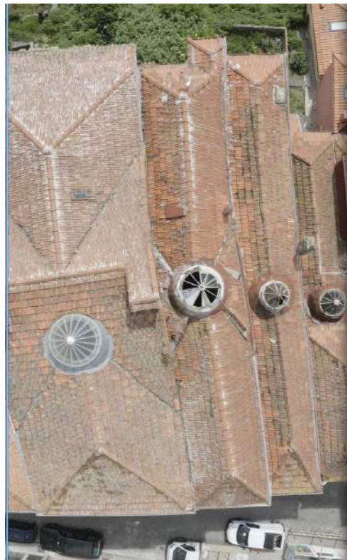
Fig. 32 – Claraboias cónicas visivelmente degradadas ao lado de uma renovada. Imagem captada via drone por João Pereira.
