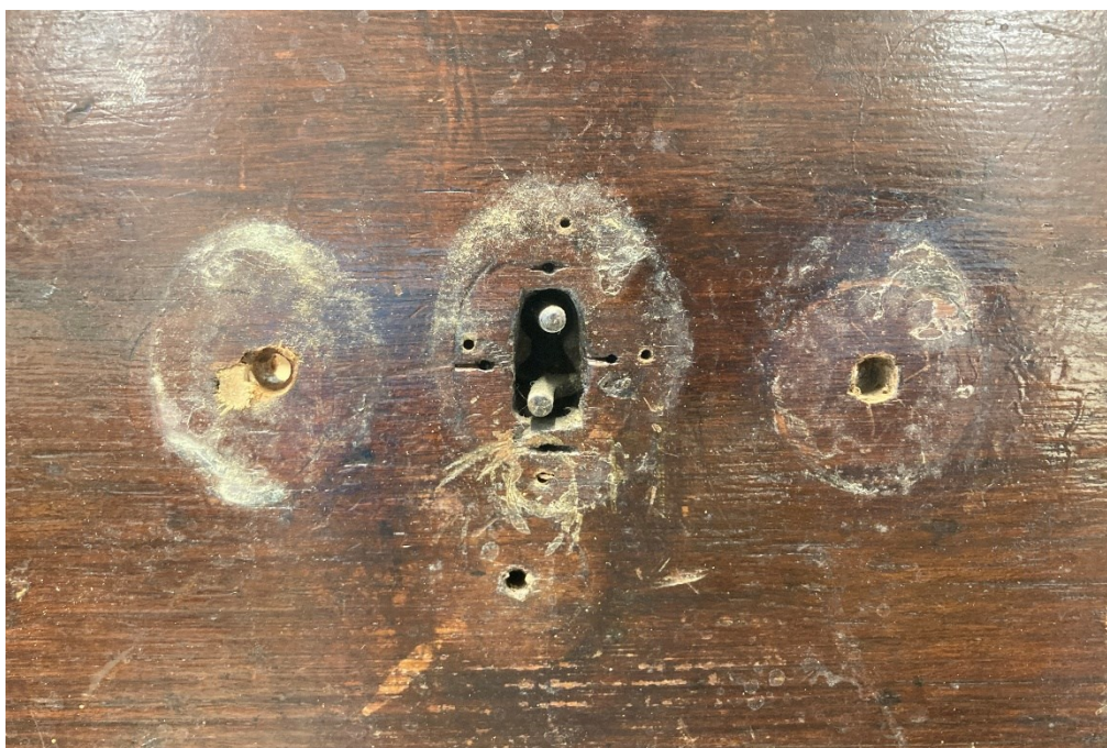
Fig. 37 – Marcas de desgaste e orifícios presentes na madeira subjacente às ferragens removidas de uma das gavetas (fotografia do autor).
