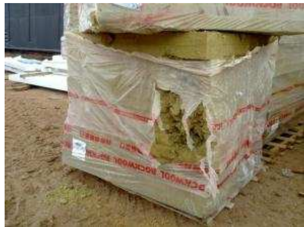
Figura 17: Material danificado por uma máquina
