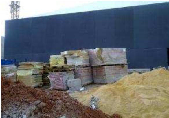
Figura 16: Materiais danificados pela chuva
