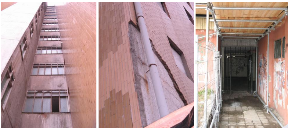
Danos no edificado
