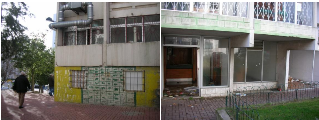
Vandalismo ao nível dos pisos térreos
