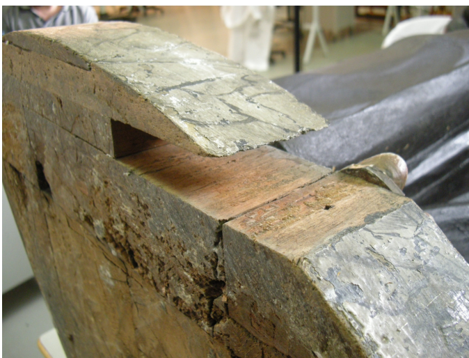
Fig.114 – Pormenor da zona de destacamento
