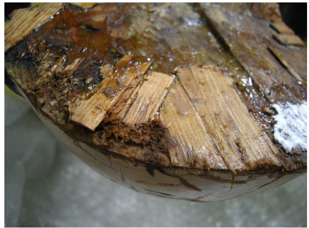
Fig.163 – Pormenor de uma zona onde se removeu o adesivo original
