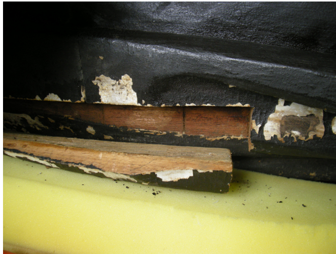
Fig.120 – Pormenor da zona de destacamento
