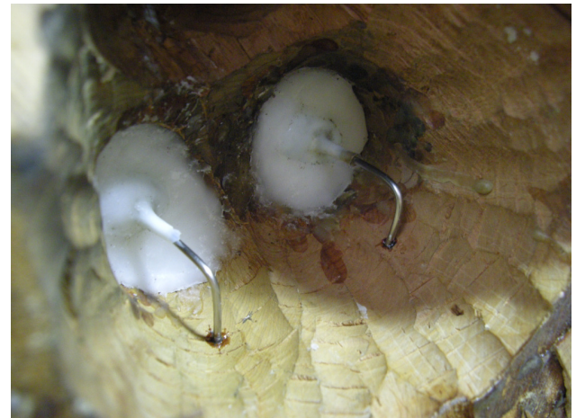
Fig.177 – Pormenor da aplicação dos dois pequenos espigões inoxidáveis que servirão de reforço
