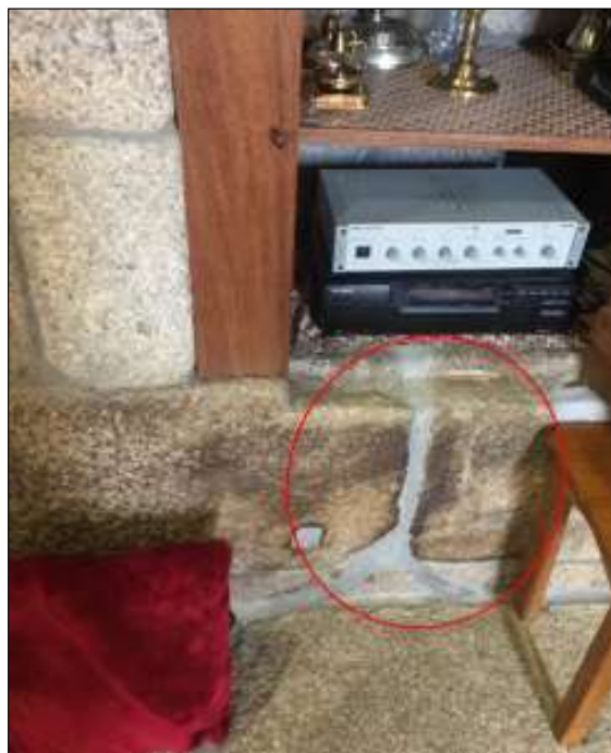
Figura 20: Evidência de selagem de juntas da pedra com argamassa de cimento tipo Portland. Créditos: João Sandes, 2020
