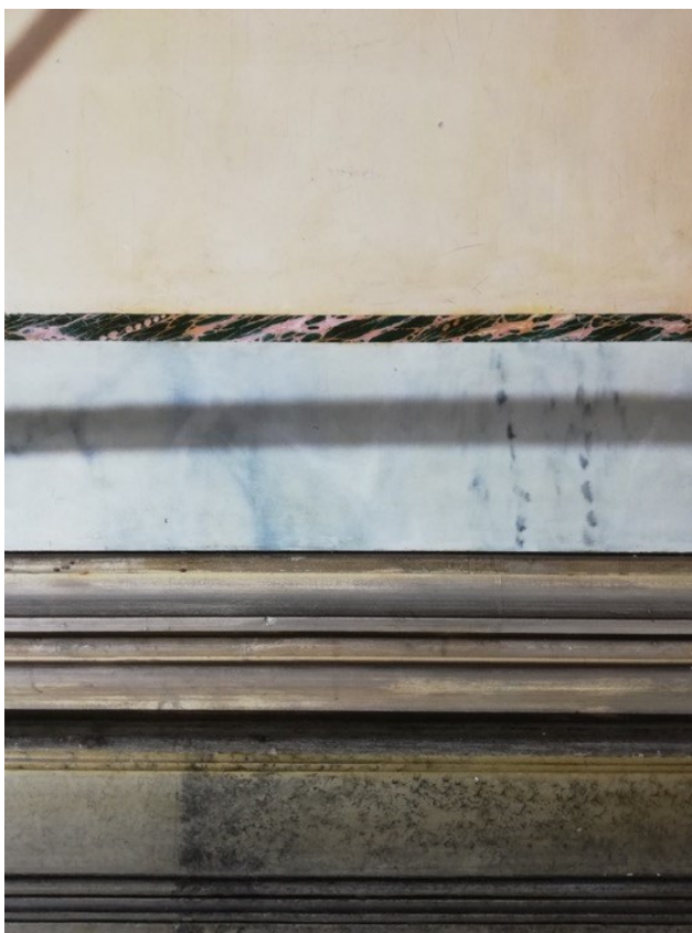
Figura 82- Sujidade moldura e verniz do rodapé oxidado Parede I. (Inês Magalhães ©)
