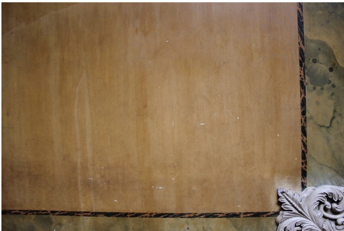
Figura 154- Antes da intervenção parede III. (Inês Magalhães ©)
