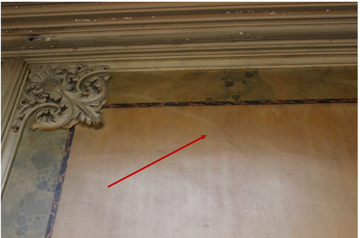
Figura 75- Fissuras diagonais no bordo superior da 2ª parte da pintura na Parede III. (Inês Magalhães ©).
