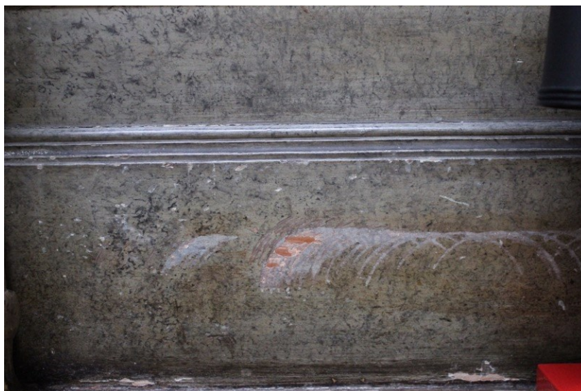
Figura 53- Impactos e golpes causados no rodapé Parede I. (Inês Magalhães ©)
