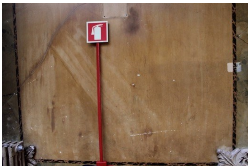
Figura 54- Manchas castanhas de intervenções anteriores e golpes Parede I. (Inês Magalhães ©)
