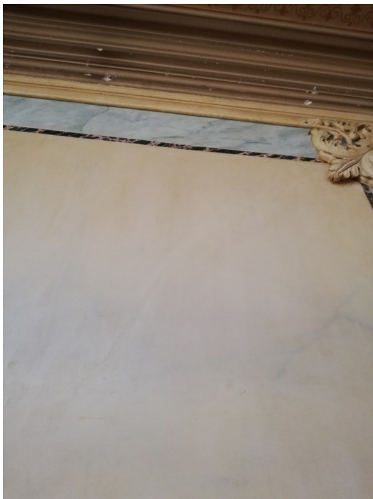
Figura 113- Reintegração cromática da fissura principal parede I. (Inês Magalhães ©)
