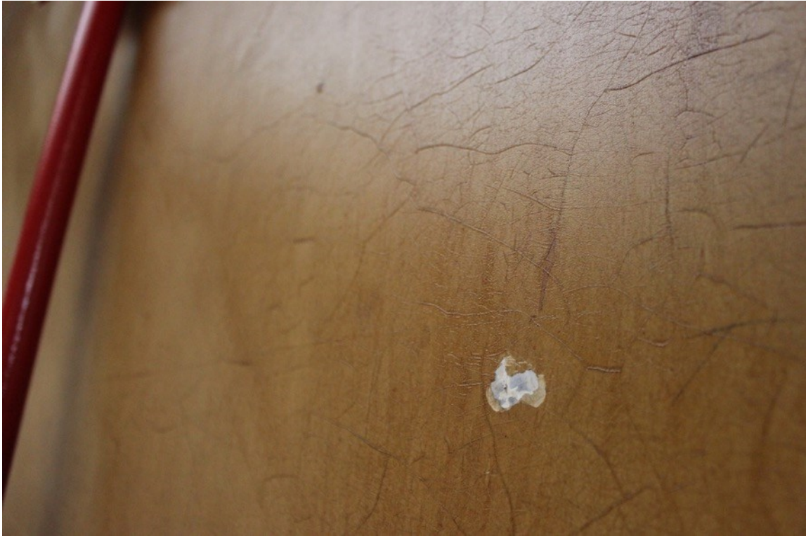
Figura 58- Fissuração e lacuna na Parede I. (Inês Magalhães ©)
