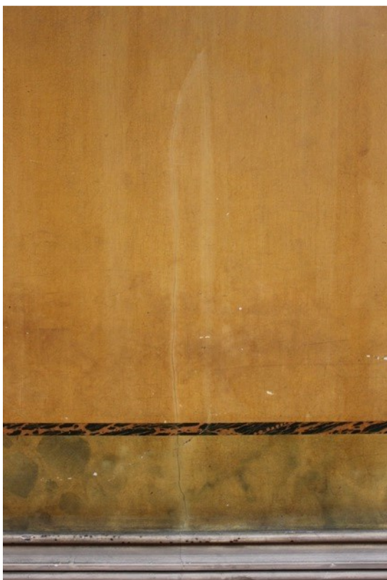
Figura 68- Fissura vertical parede III. (Inês Magalhães ©)
