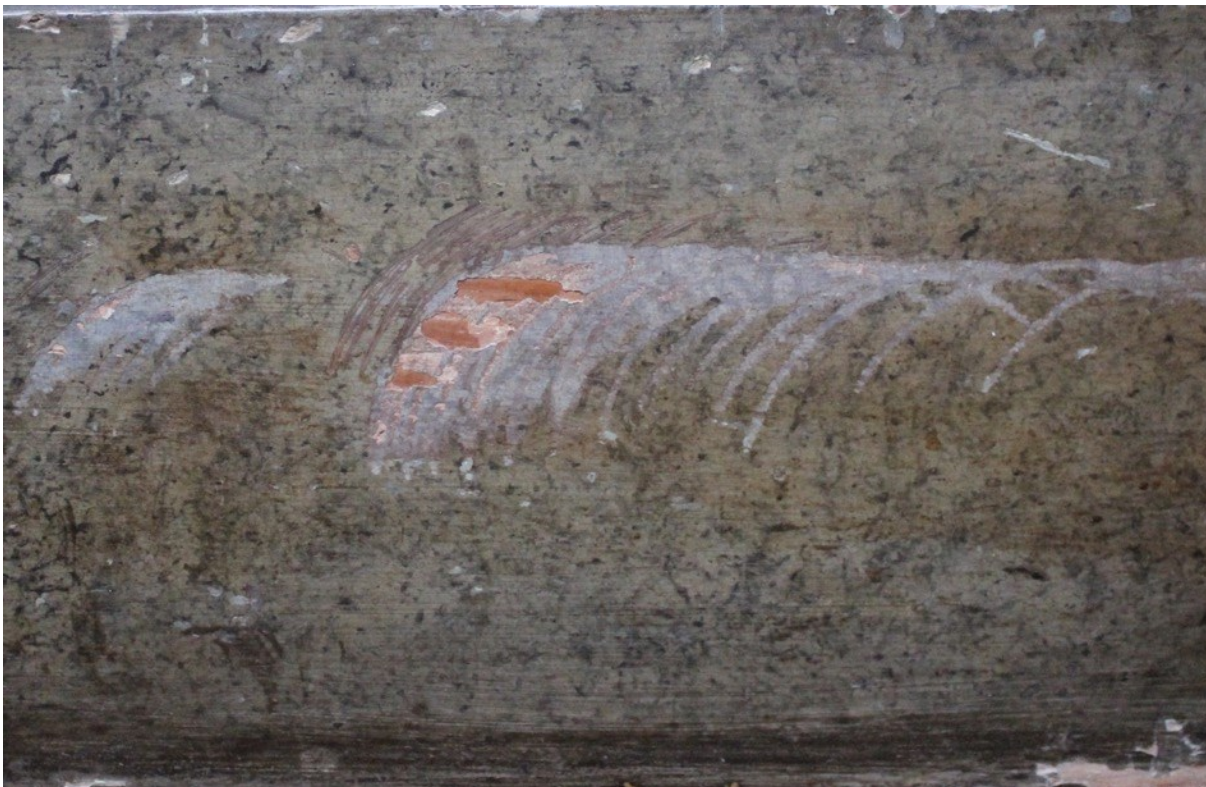
Figura 160- Antes rodapé Parede I. (Inês Magalhães ©)
