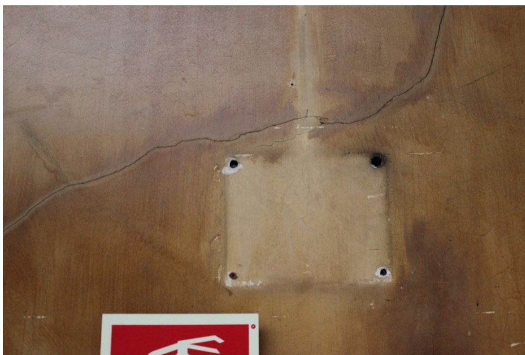
Figura 61- Instalação inadequada de sinalização de infraestruturas de combate ao incêndio Parede I. (Inês Magalhães ©)
