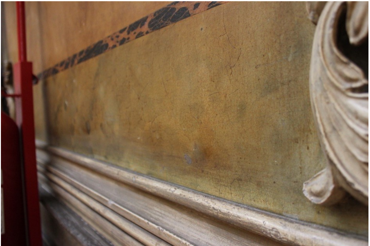
Figura 56- Oxidação do verniz da pintura e sujidades na moldura Parede I. (Inês Magalhães ©)
