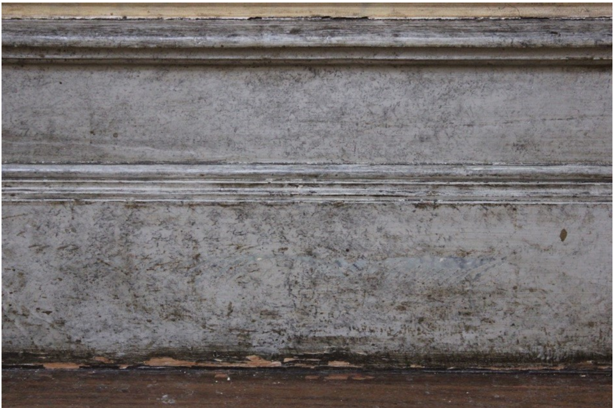
Figura 129- Rodapé pintura I. (Inês Magalhães ©)
