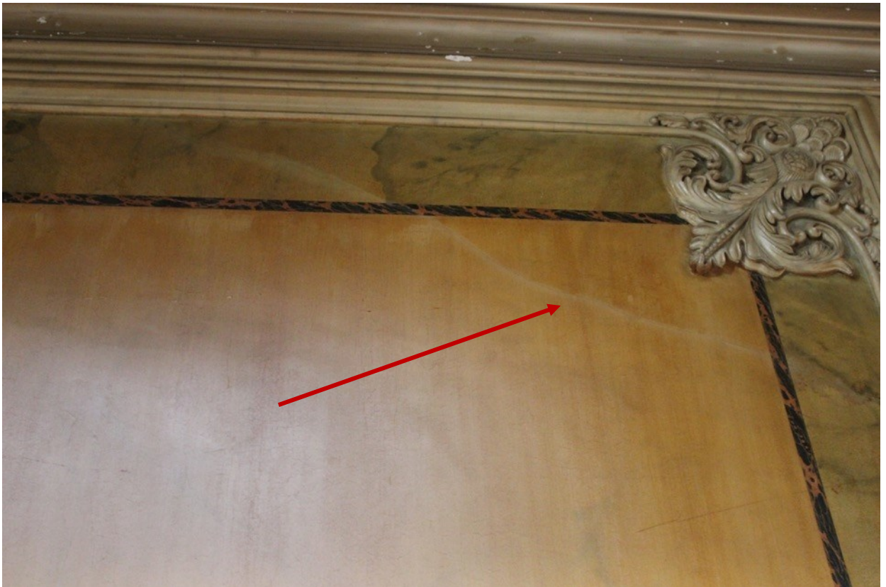
Figura 74- Fissuras diagonais no bordo superior da 2ª parte da pintura na Parede III. (Inês Magalhães ©).
