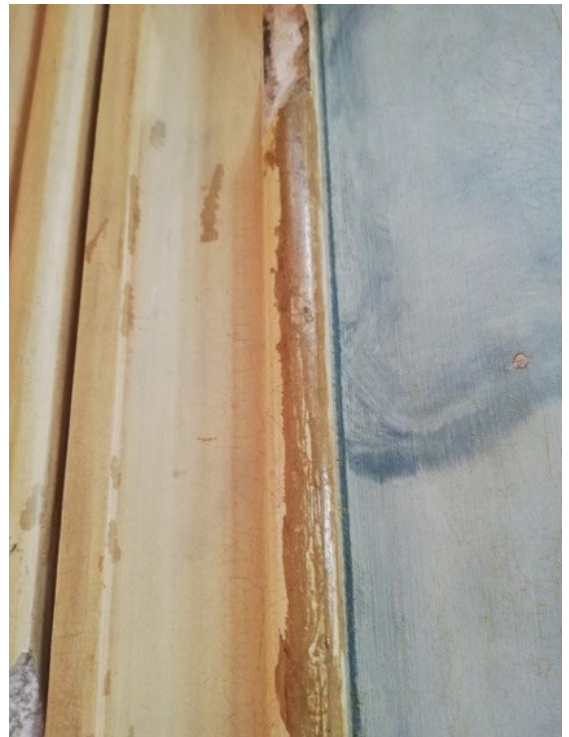
Figura 124- Manchas na moldura insolúveis com etanol Parede I. (Inês Magalhães ©)
