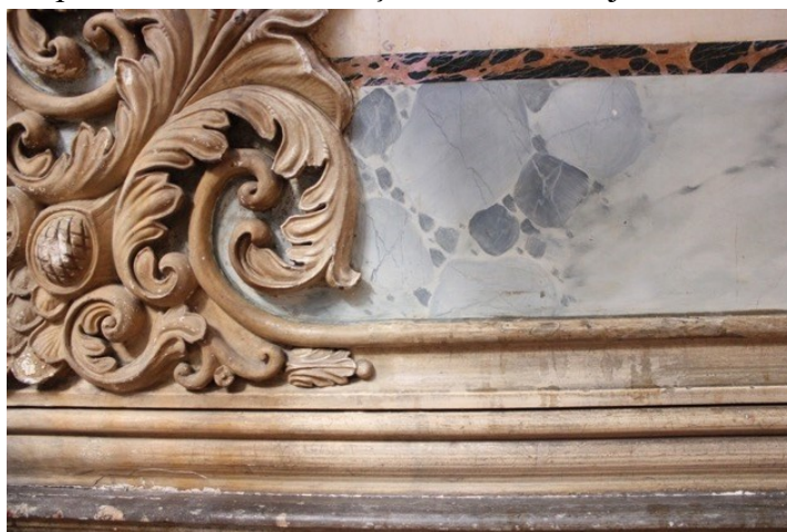
Figura 10- Estado de conservação inicial da moldura e ornato. (Inês Magalhães ©)
