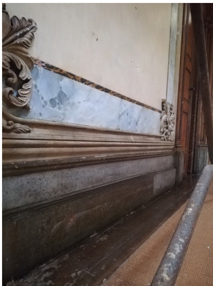
Figura 119- Moldura parede I antes da intervenção. (Inês Magalhães ©).
