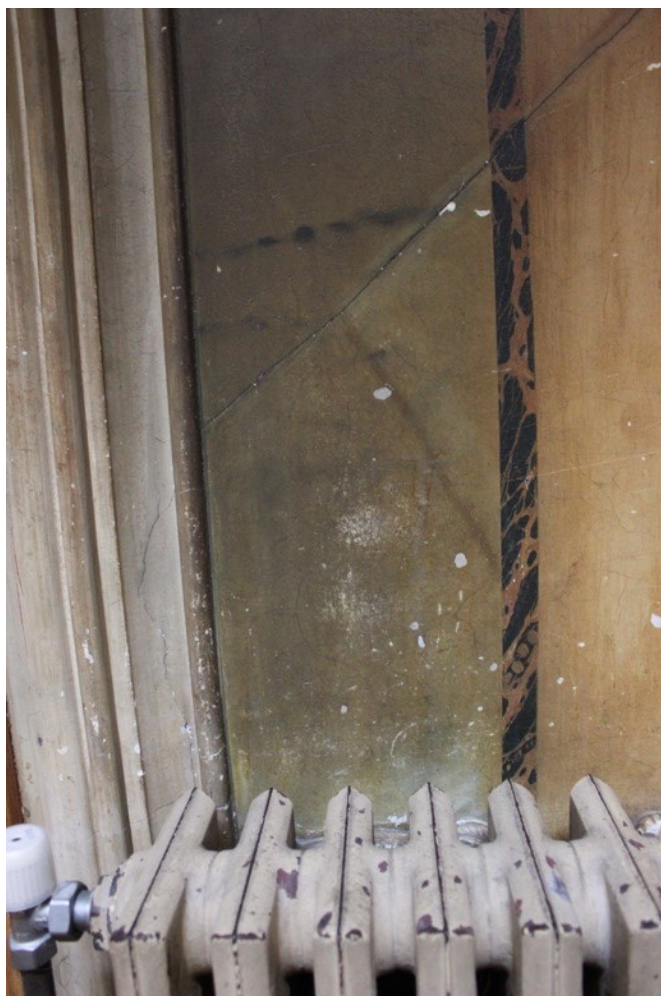
Figura 60- Danos causados pela presença do aquecedor. (Inês Magalhães ©)
