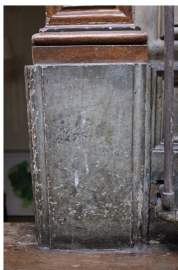
Figura 55- Rodapé com lacunas devido aos impactos Parede I. (Inês Magalhães ©)
