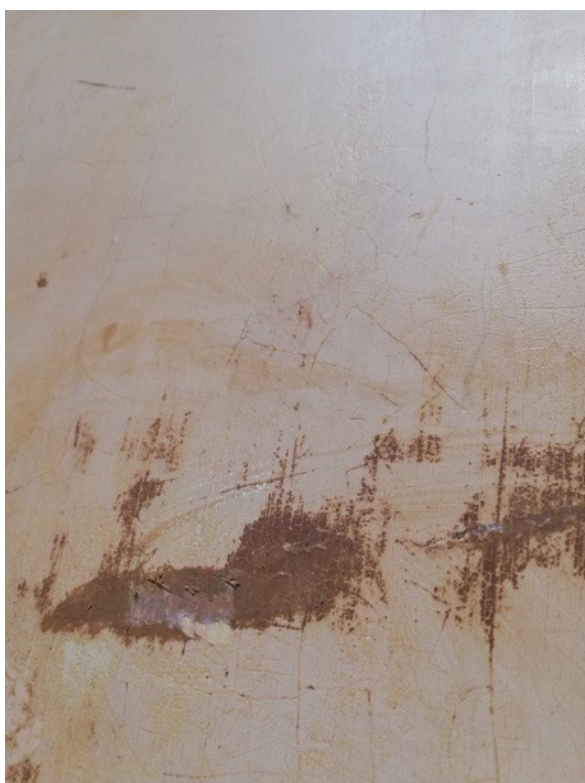
Figura 105- Preenchimentos de lacunas realizados em intervenções anteriores. (Inês Magalhães ©)
