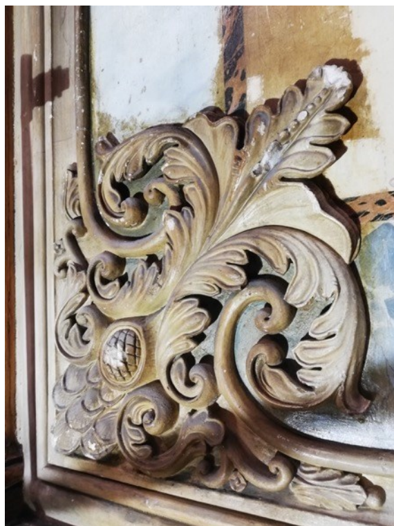
Figura 118- Estado de conservação do ornato que se situa atrás do aquecedor. (Inês Magalhães ©)
