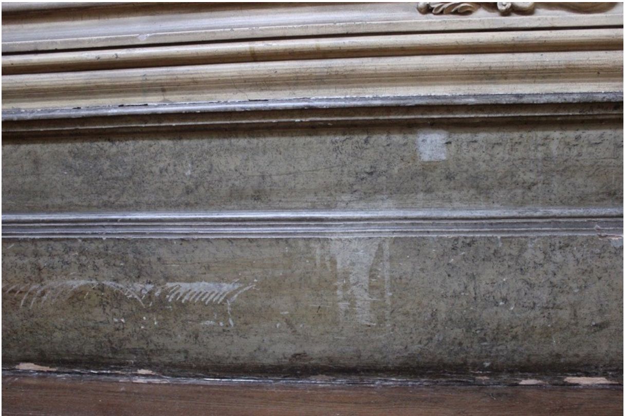
Figura 138- Rodapé antes da intervenção parede I. (Inês Magalhães ©)
