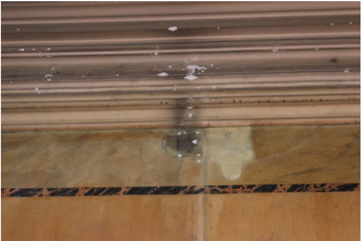
Figura 51- Sujidades na pintura e moldura e mancha de descoloração Parede I. (Inês Magalhães ©)
