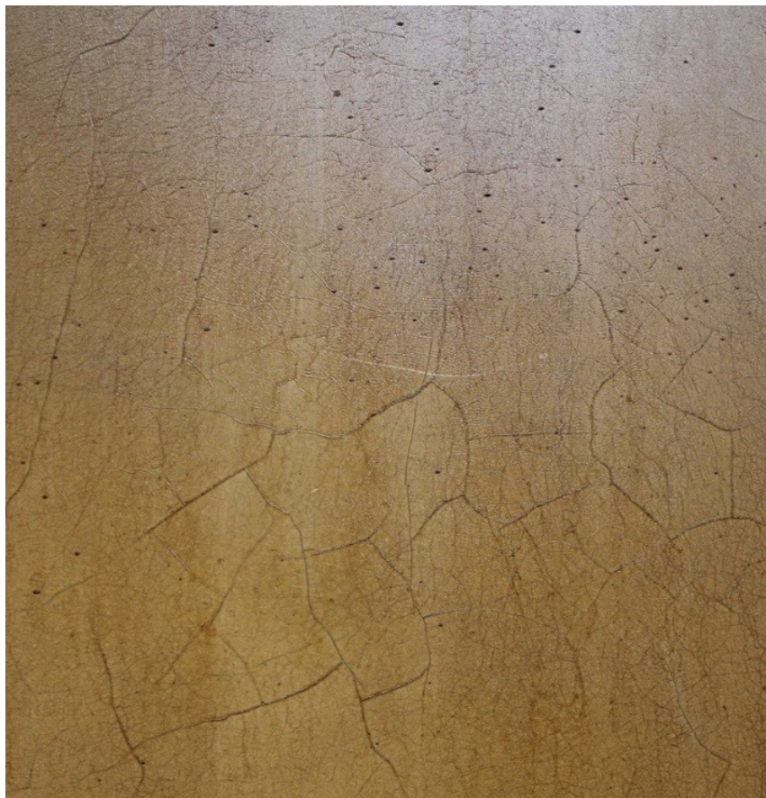
Figura 59- Fissuração e pigmentação preta na Parede III. (Inês Magalhães ©)
