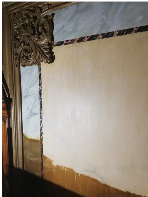
Figura 92- Aparência da pintura depois de retirar o verniz. (Inês Magalhães ©)
